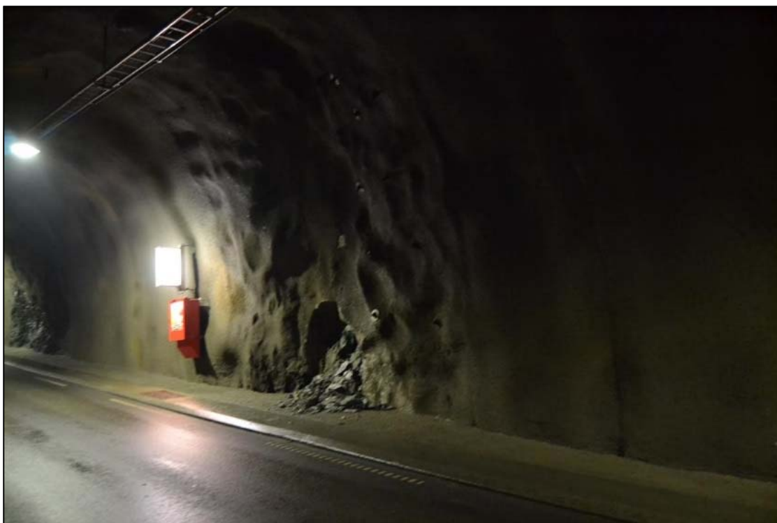
Bilde 1. Nedfallslokaliteten i Talgjetunnelen ved skap 64 og ca. ved pel 950.
