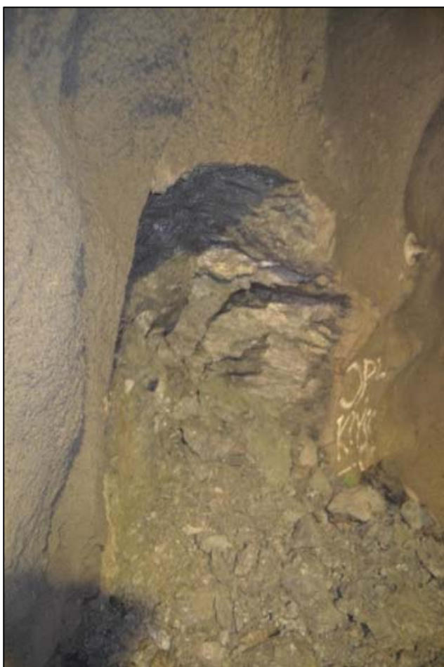
Bilde 2. Hullet i tunnelvegg er utfall av leiraktig amfibolitt.
