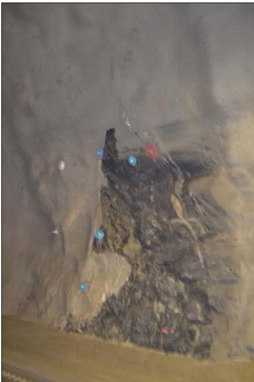
Bilde 4. Tegn på tidligere nedfall og spredt bolting på venstre tunnelvegg på samme lokalitet.
