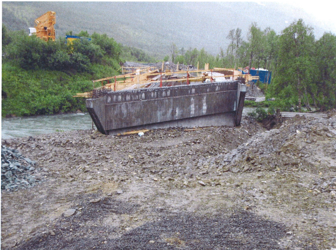
Skjevsetninger nordre fundament
