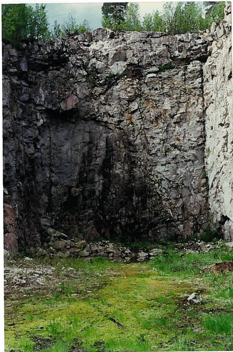
Fig. 2 Bildet er tatt mot VNV og viser deler av massetak I ved Andsvatnet. Bergarten er oppsprukket og stedvis farget rustred. Legg merke til forkastningen som går fra øvre venstre hjørne mot nedre høyre hjørne.
