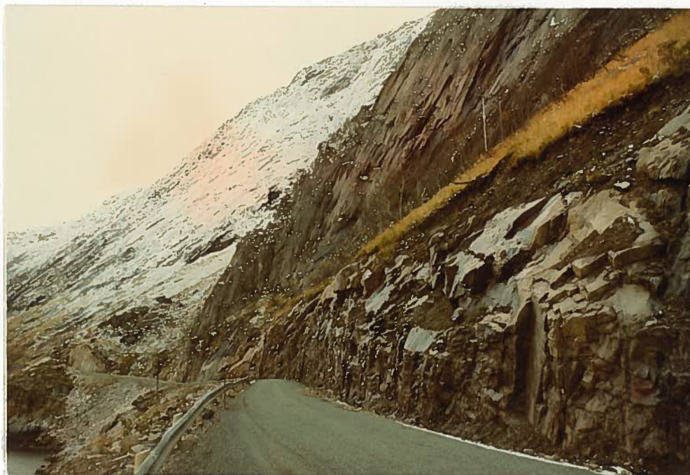
Fig. 5 Vanskelig skredparti km.pel. 2,4 - 2,7
