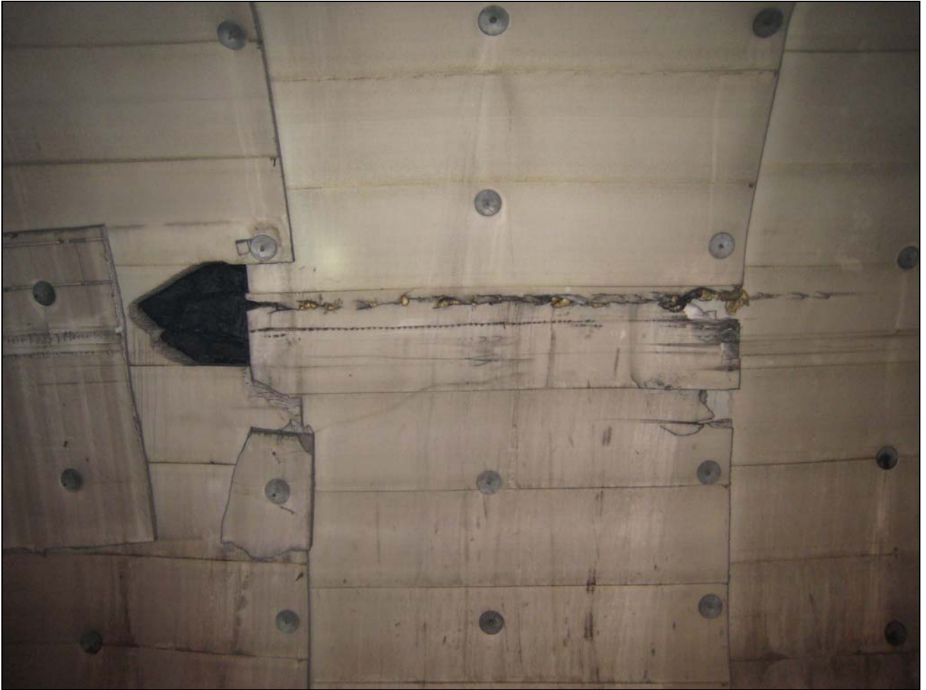
Foto 1: Ca ved km 16,985, skade i PE- skum plater.
