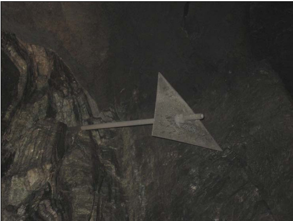
Foto 4: Ca ved km 18,630, løs bolt.
