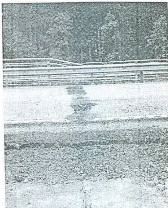
Figur 7. Sprekk i overgang mellom avlastningsplate og betongplate over EPS laget
