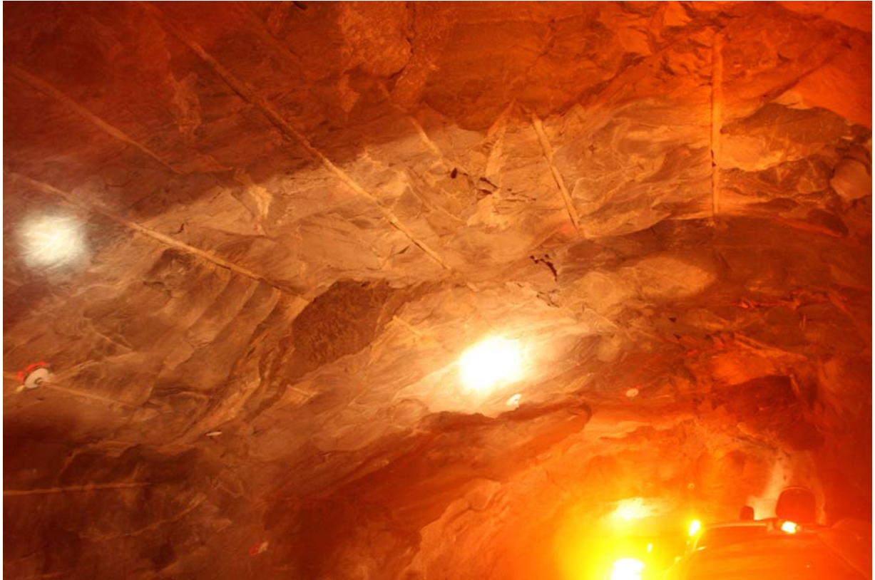
Foto 3. Havarinisje 5. Synlige borpiper i heng.
