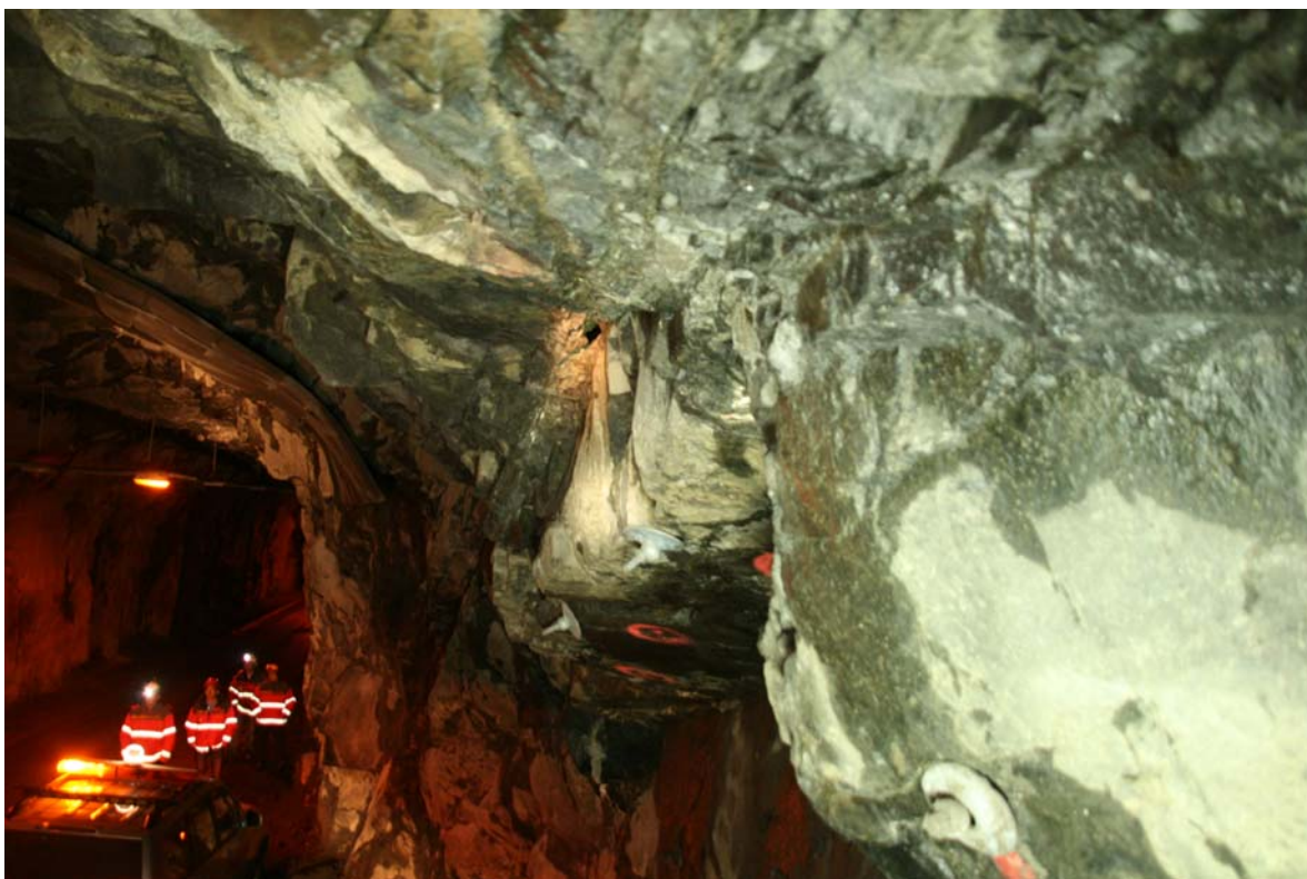
Foto 1. Havarinisje 1. Oppsprekning langs foliasjonen i eksisterende nisje.
