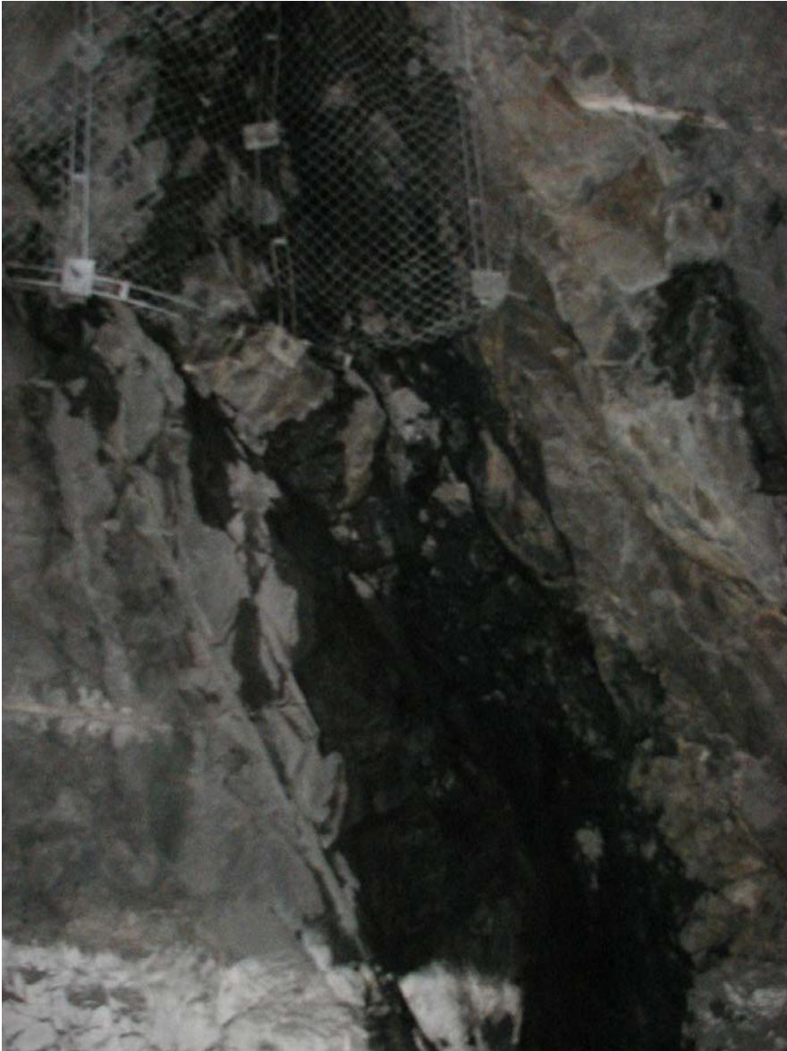
Figur 1: Sleppe (0,5-1 m brei) med grå leire ved Pel 1475 i Ryggedalstunnelen.
