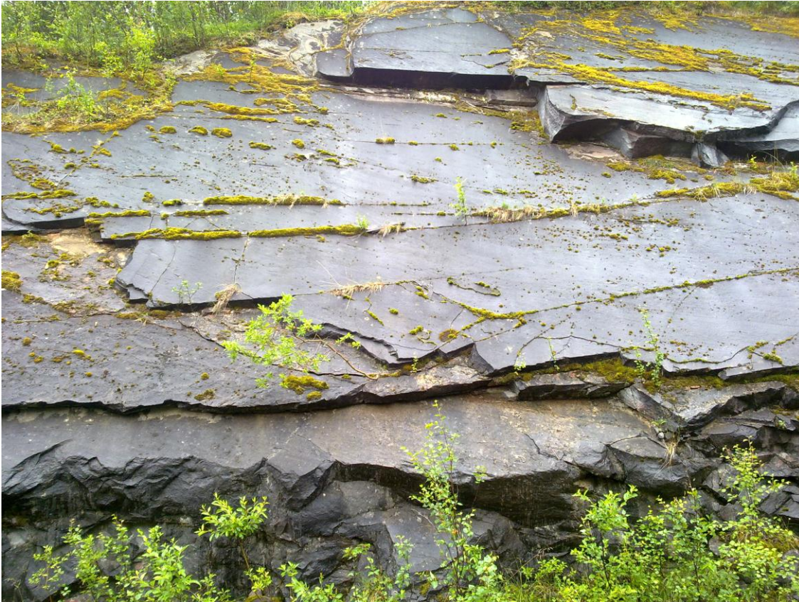
Foto 3: Ved ~km 7.880. Sprekker hvor mose vokser er en indikasjon på vannføring og kan forårsake is-sprengning.
