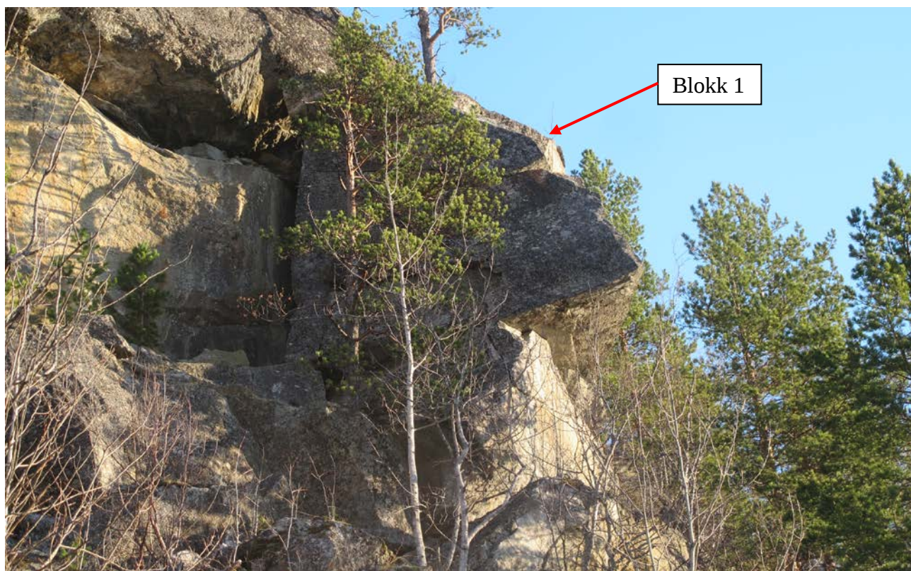
Foto 3: Tatt mot Ø. Det er en baksprekke på ca. 20 cm, men blokken står stablet horisontalt på underliggende fjell/blokker.
