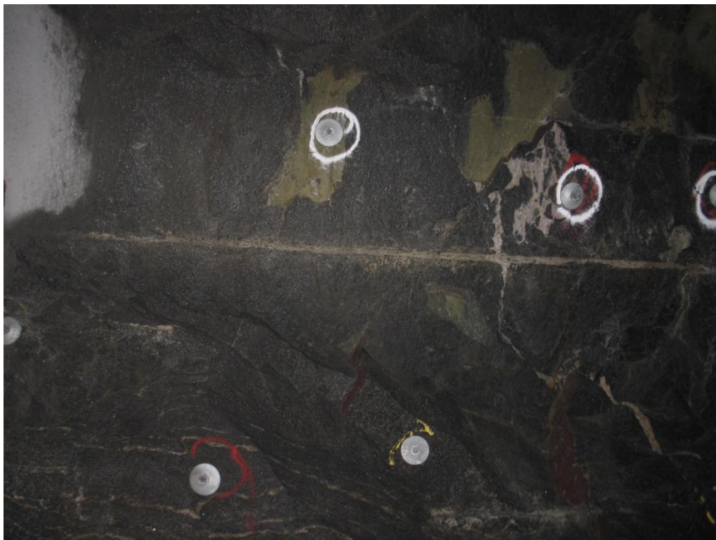
Foto 3: Påmerkede bolter med løse skiver ved pel 145
