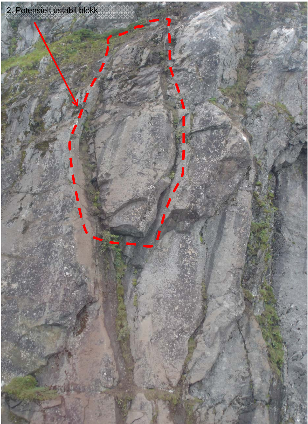
Fig. 8. Større flak med underliggende sprekk, som bør undersøkes nærmere.
