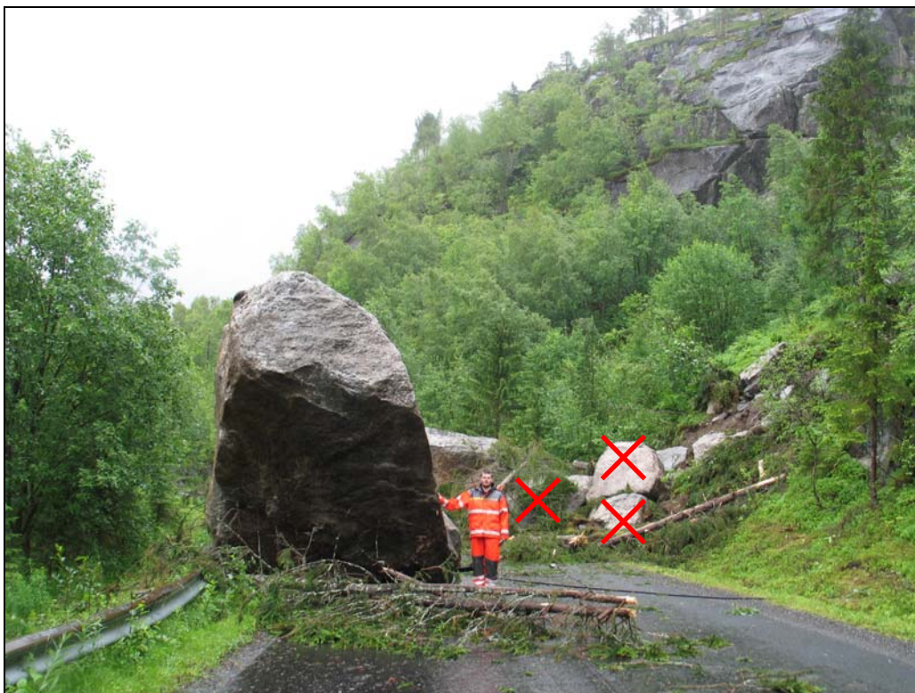
Foto 13: Blokk på vegen. Bilde tatt fra vest.
