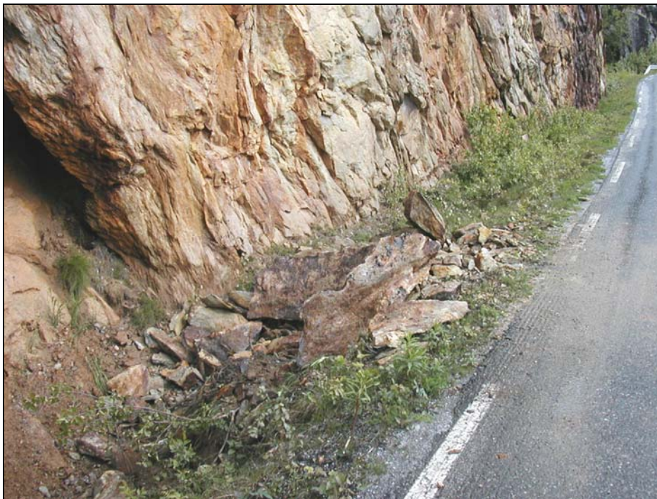
Foto 2: Fv612-01, km 2.040. 2 m 3 rasmasse i grøft etter steinsprang 27.05.2004.
