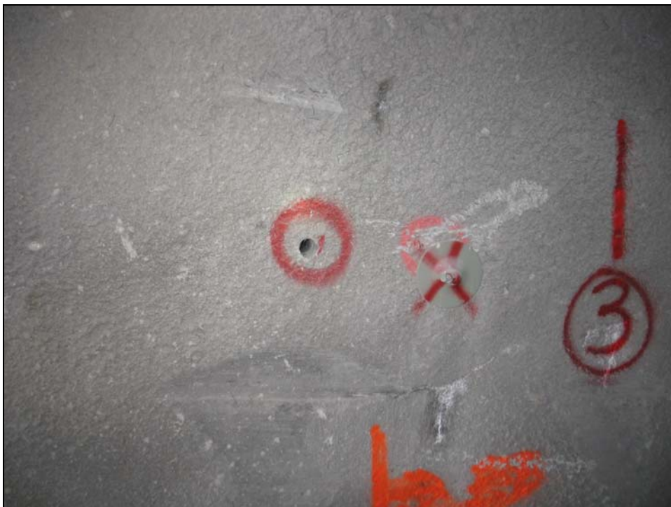
Foto 1: 5870 Eksempel på boret boltehull uten bolt.
