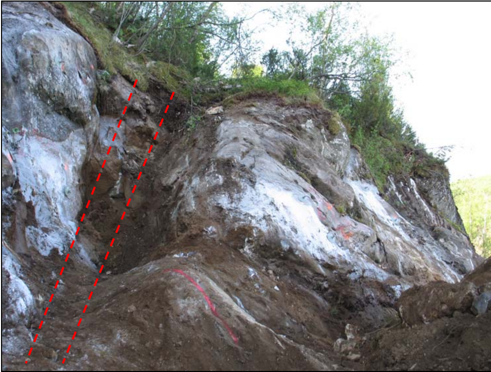
Foto 3: Sprekkesone. Bilde tatt mot SV.
