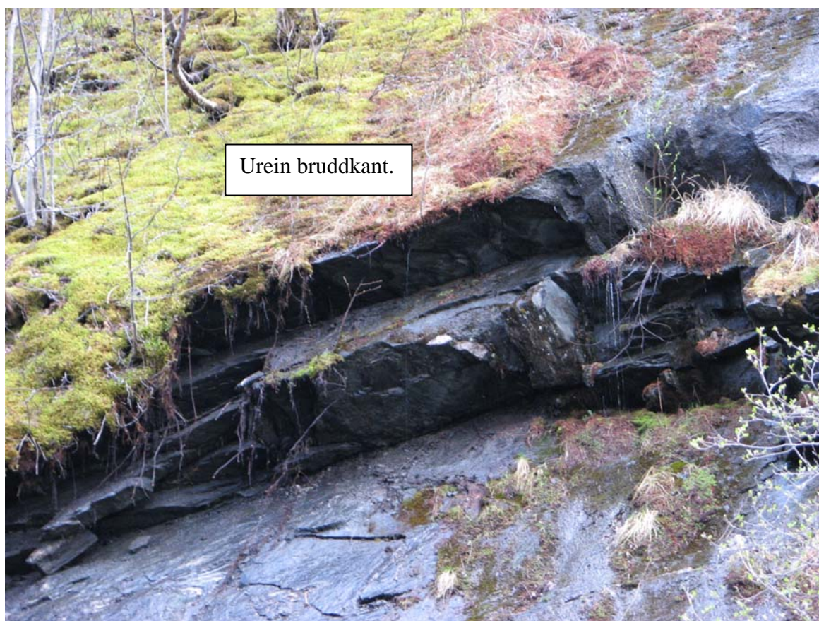
Foto 4: Detaljfoto av urein bruddkant med potensielt løse blokker.
