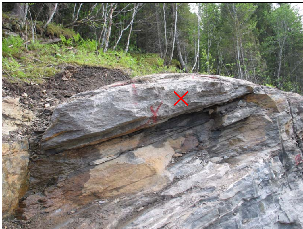
Foto 3: Søndre bergskjæring. I nordre del.
