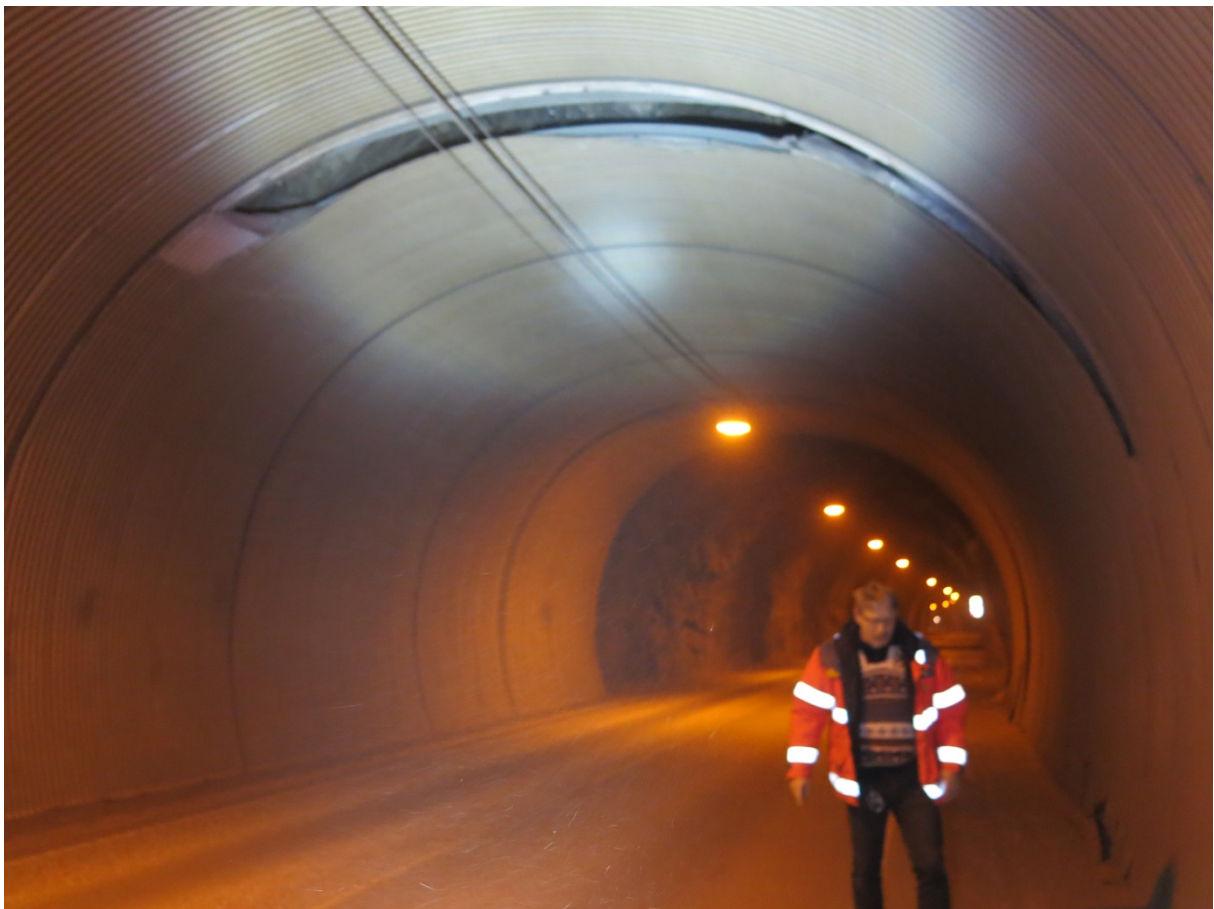
Foto 1. Aluminiumsplater ved profil ca. 60-85. Hull i platene synes tydelig.
