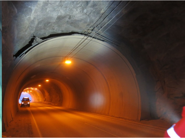
Foto 3. Endene av platene er ikke tette.
