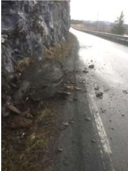
Figur 2: Nedfalte masser. Foto: Mesta.
