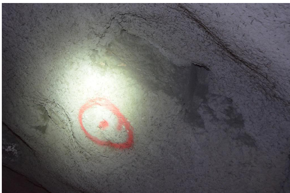
Figur 2 Tidligere påmerket bolt, men som ikke er satt. Pel nr. 91.
