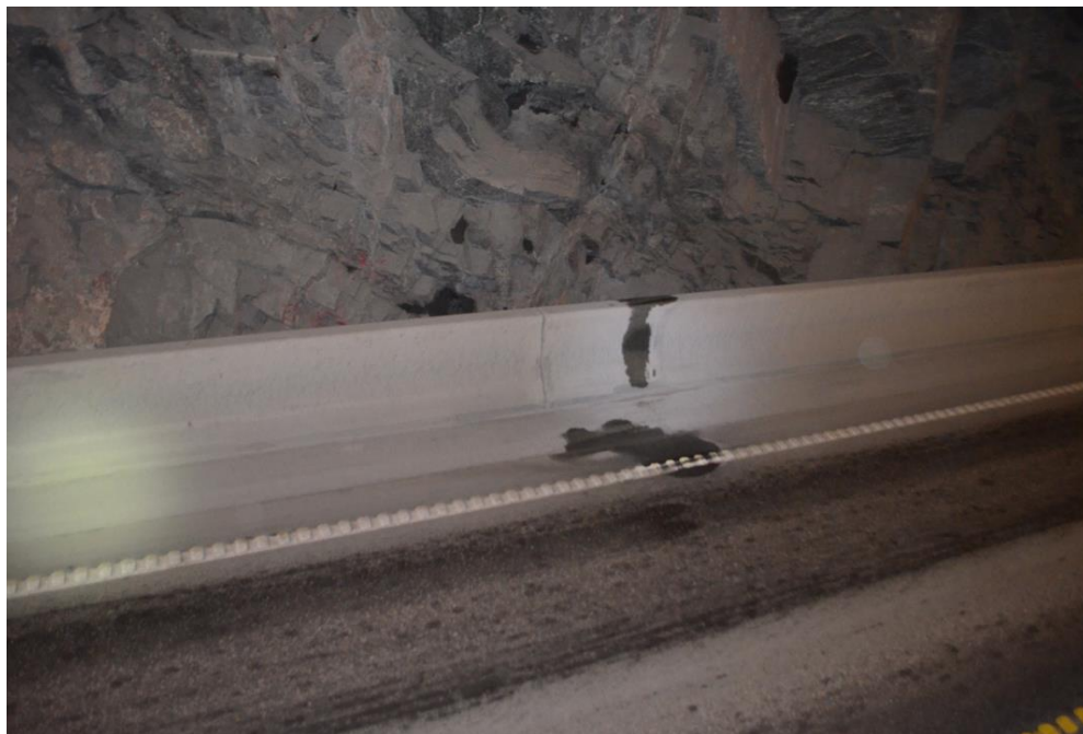
Figur 6 Lekkasje med ca. 4 drypp i minuttet. Pel nr. 375.
