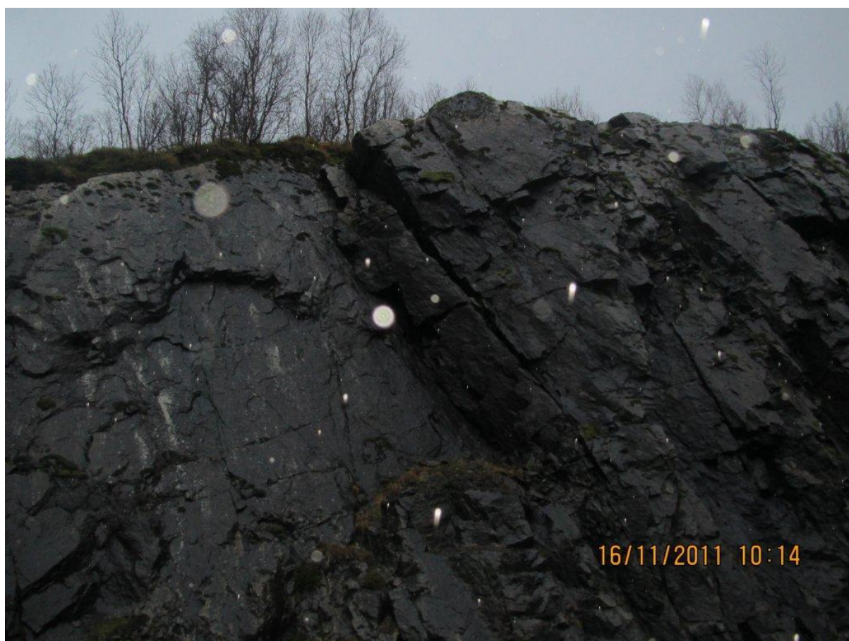
Foto 2: Løs blokk i bergskjæring. Fra Magne Berg
