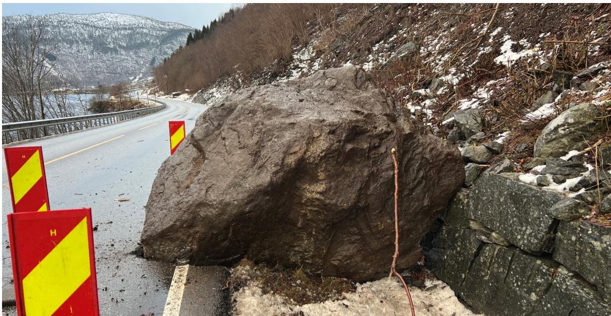
Figur 2: Blokka ligger i hovedsak i veggroft, tett inntil en lav tørrmur. Deler av blokk ligger i vegbanen og det er skade i asfalten.
