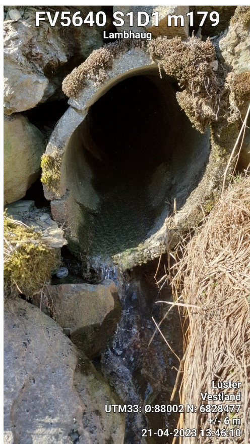
Bilde 3: Bildet viser delvis kollapset stikkrenne ved m179
