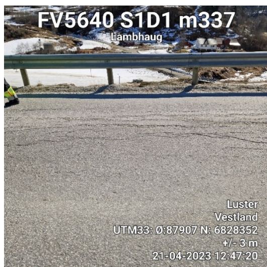
Bilde 1: Bildet viser kantsprekker langs mur
