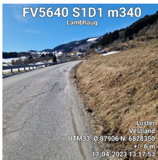
Bilde 2: Bildet viser kantsprekker langs grøft og telesprekker i vegbanen.
