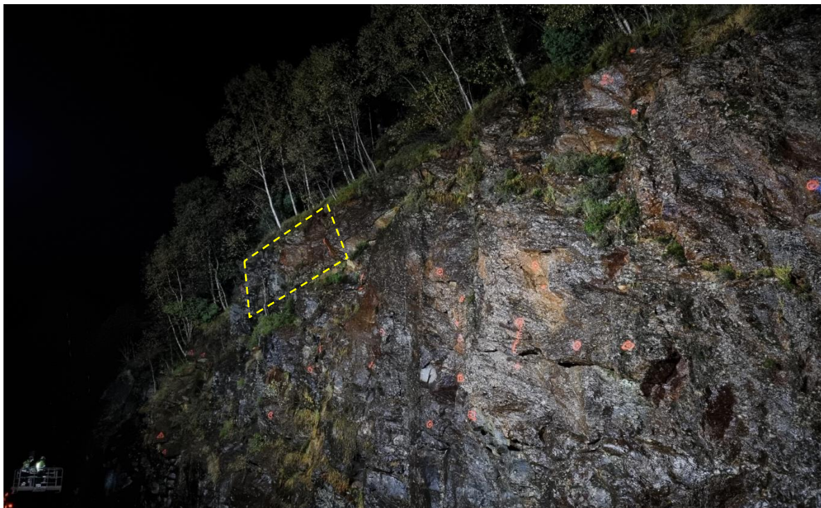
Bilde 1. Bergskjæringen i midtre deler av vegstrekket mellom m5705-5840. Det er også anvist i bergskjæringen nord og sør for den delen av skjæringen som vises i bildet. Løsneområdet for steinspranget som gikk 29. september 2023 er lokalisert midt i bildet. Særlig til høyre for dette, og som geologer i Svv også påpekte, er det ustabile bergblokker og -partier med stor sannsynlighet for nedfall. Berget sikres som anvist med Ø20 mm 1,5-4,0 m lange endeforankrede bolter (røde symboler) og steinsprangnett (gulstiplet rektangel).
