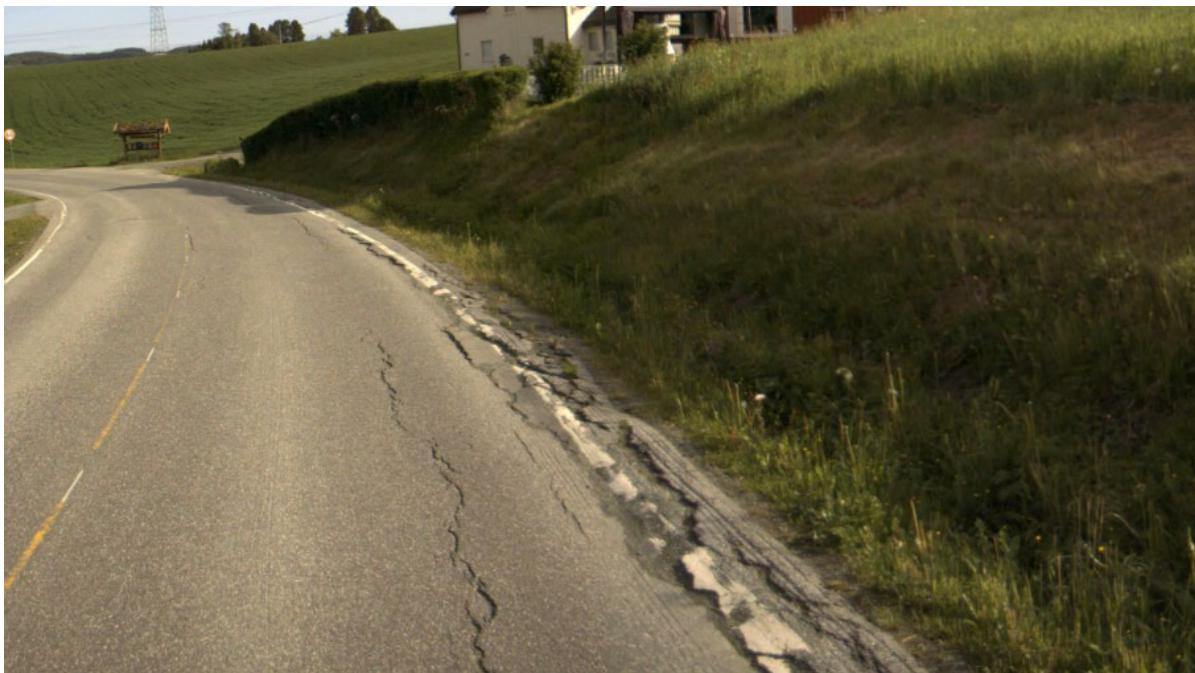
Figur 3 Eksempler på skader på skjæringssiden. Manglende kantstabilitet/drenering
