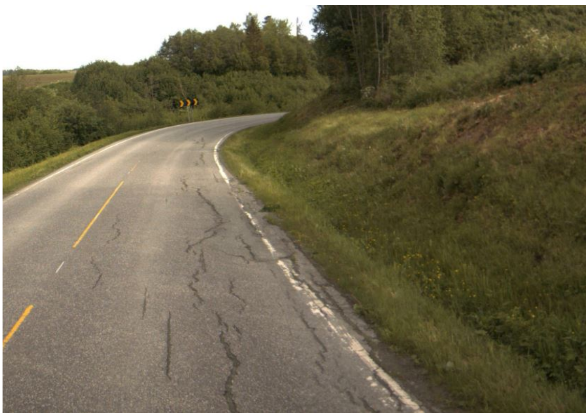
Figur 2 Eksempel på skader på skjæringsside, manglende kantstabilitet/drenering
