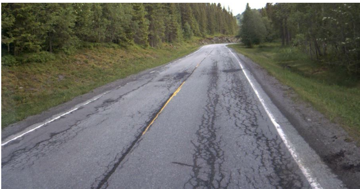
Figur 10 Krakeleringer og skader på Fv 709 S2D1 m2000-3900, sett i F2
