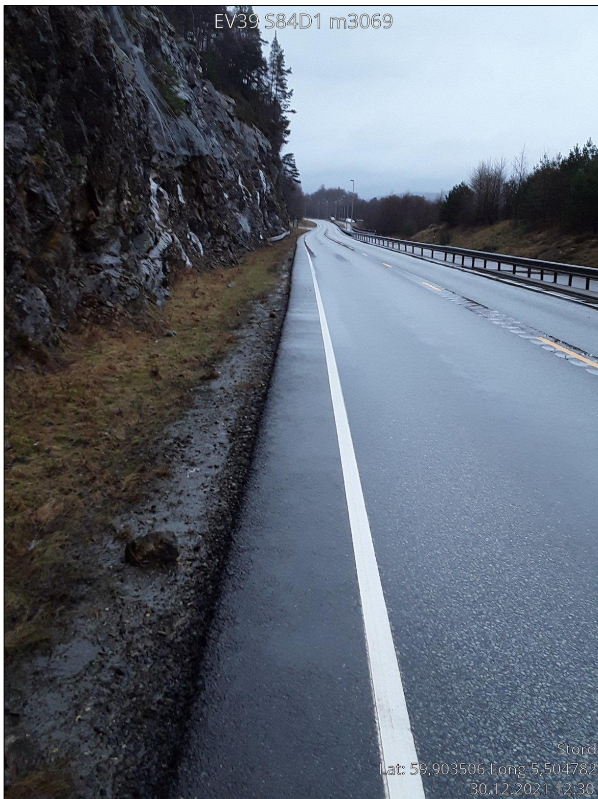
Figur 2. Nedfall i grøft. Foto hentet fra; R11 datert 30.01.2022 – Løpenummer R11-34
