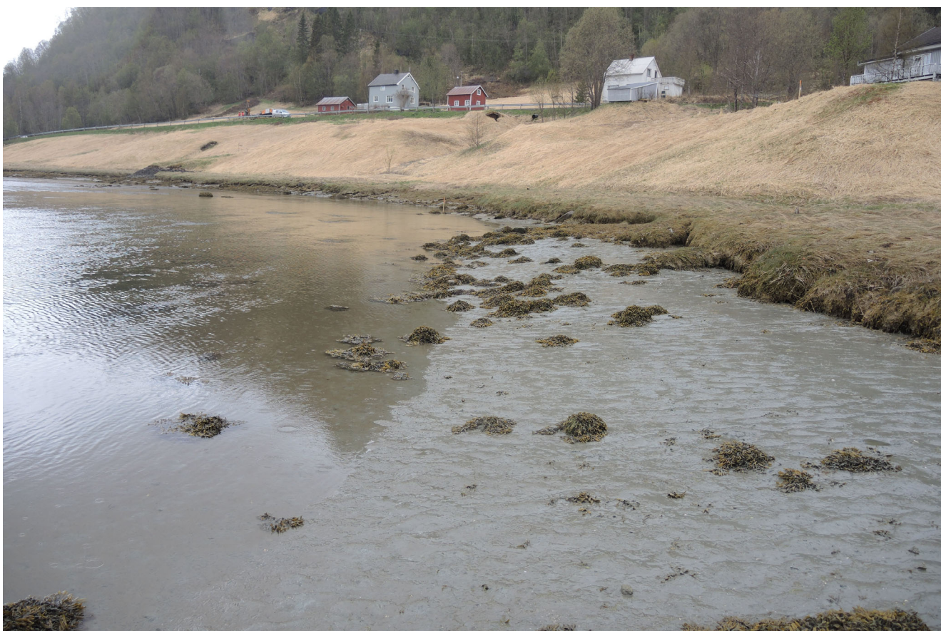
Figur 12. Elveskråning nord for Tørrfjordelva, tatt mot nordvest.
