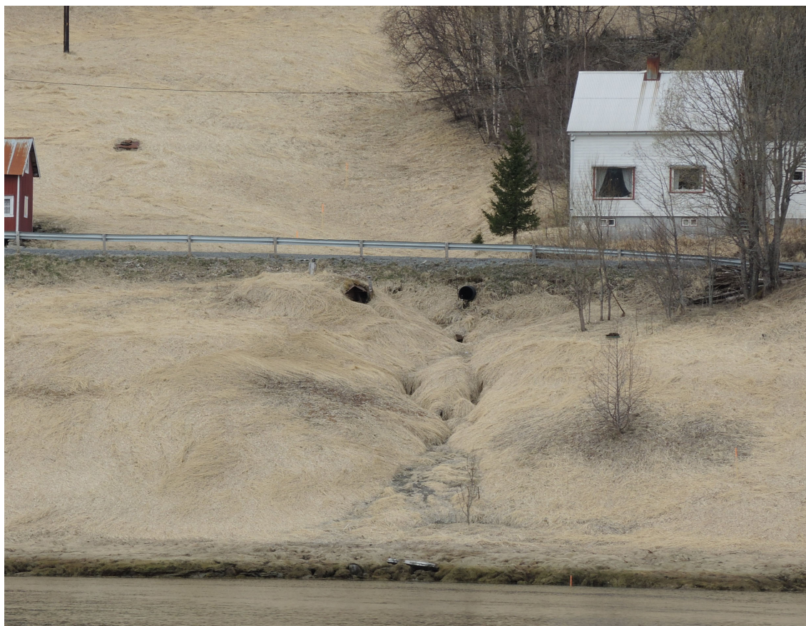
Figur 7. Bekk som eroderer.
