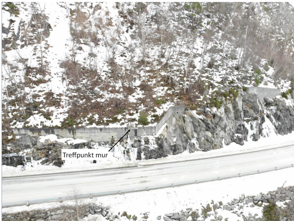
Figur 4 - Nedre del av skredbane. Merk skade på mur over veg. Foto: J Tveit, SVV
