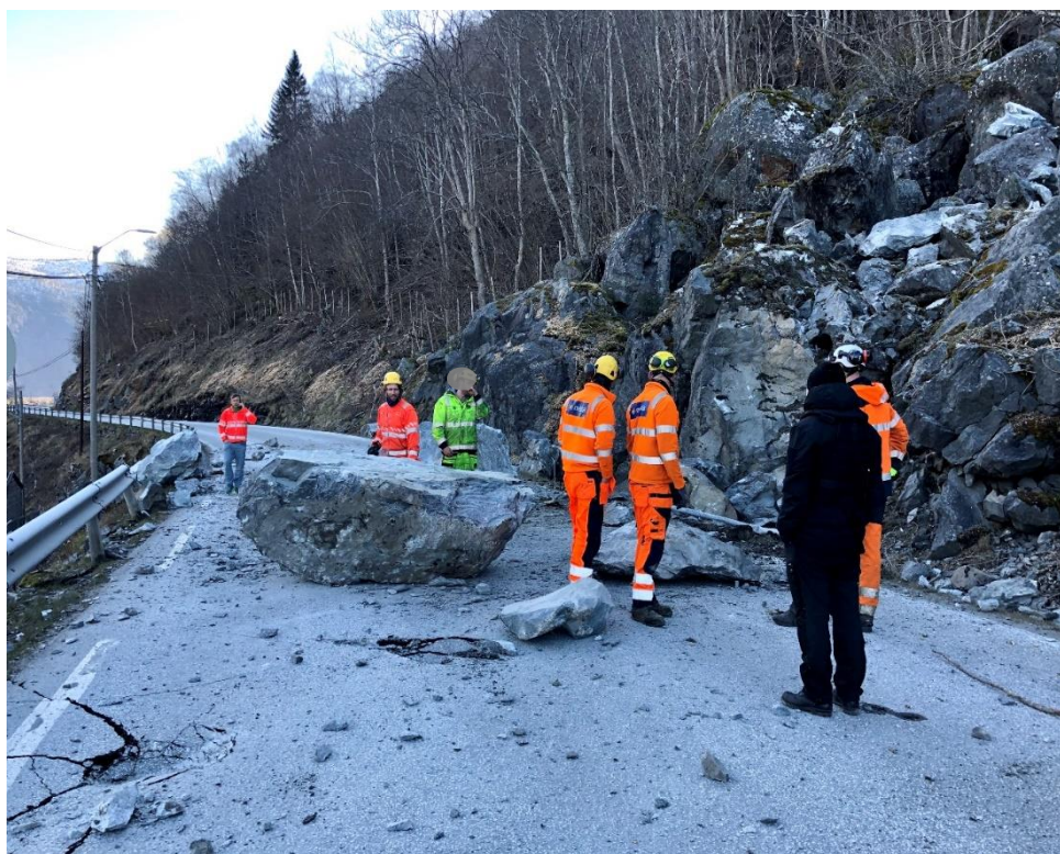
Figur 2 : Skade på autovern, veg og krasa skilt.
