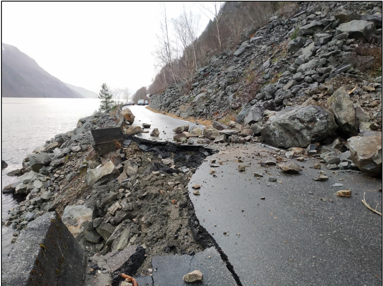
Figur 2: Steinskredet gjorde store skader på vegbanen. Vegen er slått ut i en bredde på om lag 3 meter langs en 10 meter strekning.
