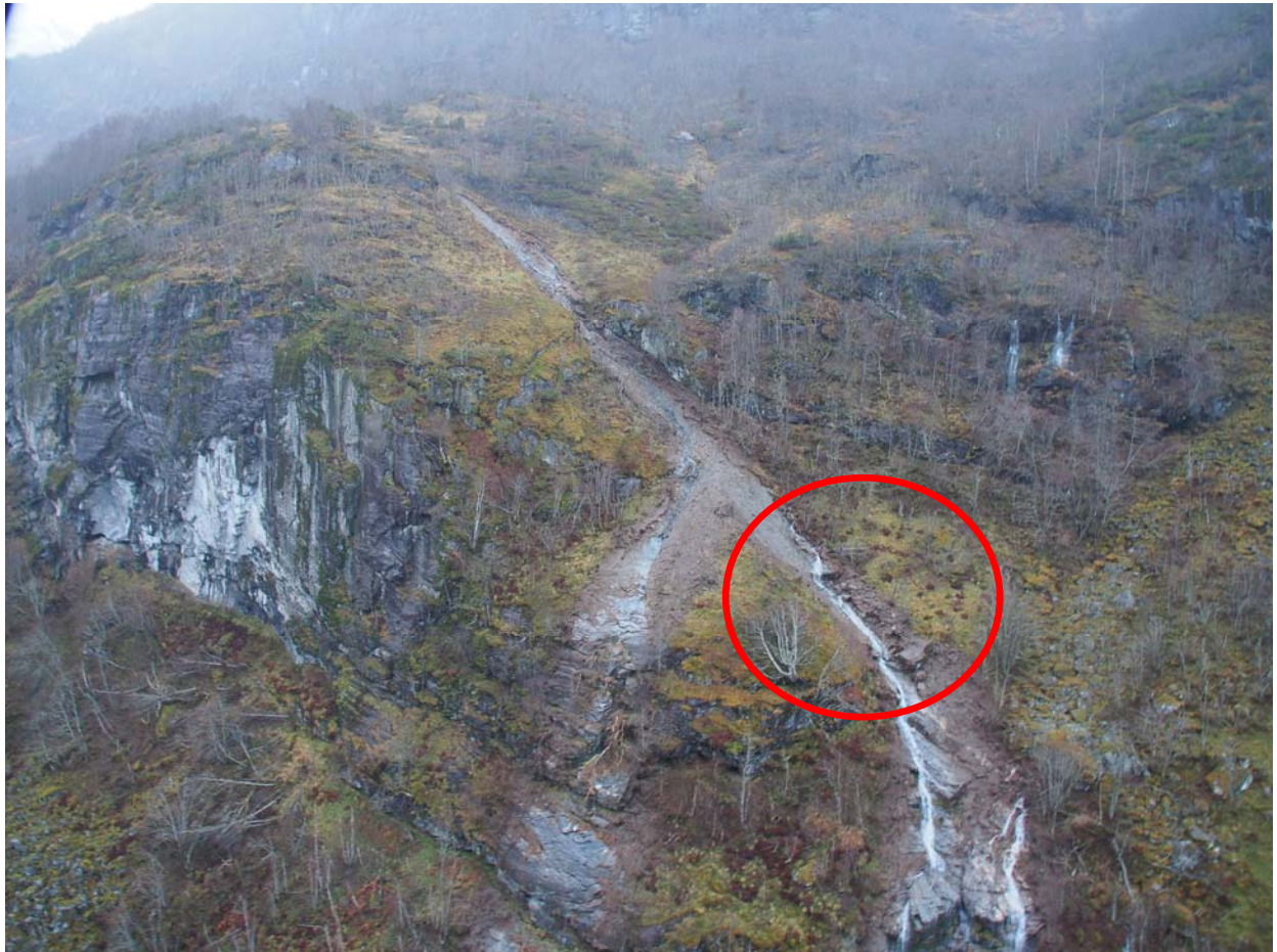
Figur 1: Ustabile blokker i austre skredløp av det minste jordskredet.
