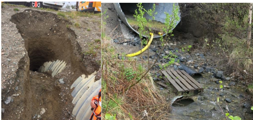
Figur 1. Innsunket masse rundt gangtunnel (Ø300) og Ø80 rør med høy vannstand.
