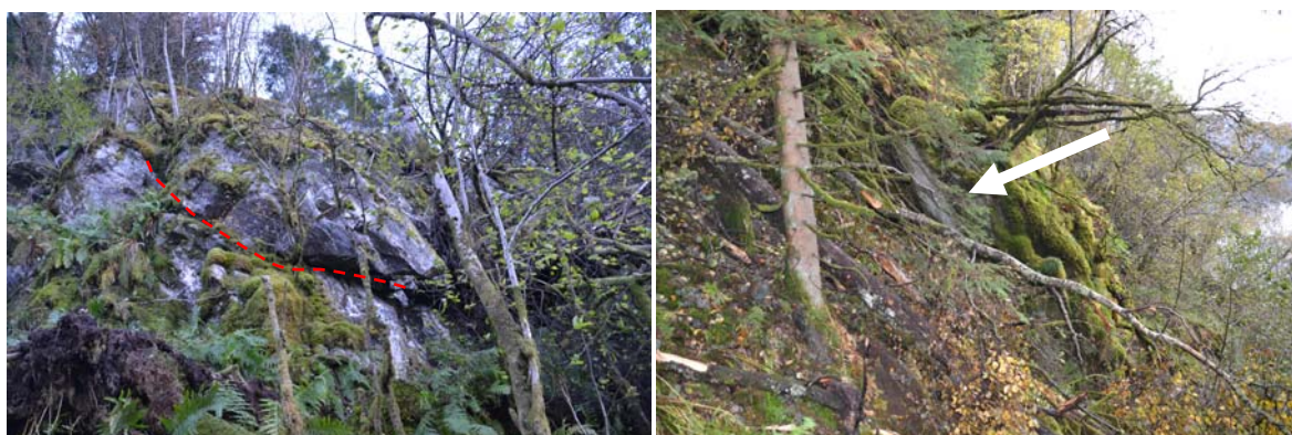
Figur 3. Eksempel på store potensielt ustabile flak i berghamrane og i terrenget ovafor km 3,770. Volumet på blokka til venstre er mange titals kubikkmeter i størrelse. Eit anna eksempel er blokka til i høgre bilete. Denne er 2-3 m 3 stor og ligg i eit ca 45° bratt terreng. Det ser ut at det har vore ein sakte utglidning av denne truleg pga fryse tineprosessar.
