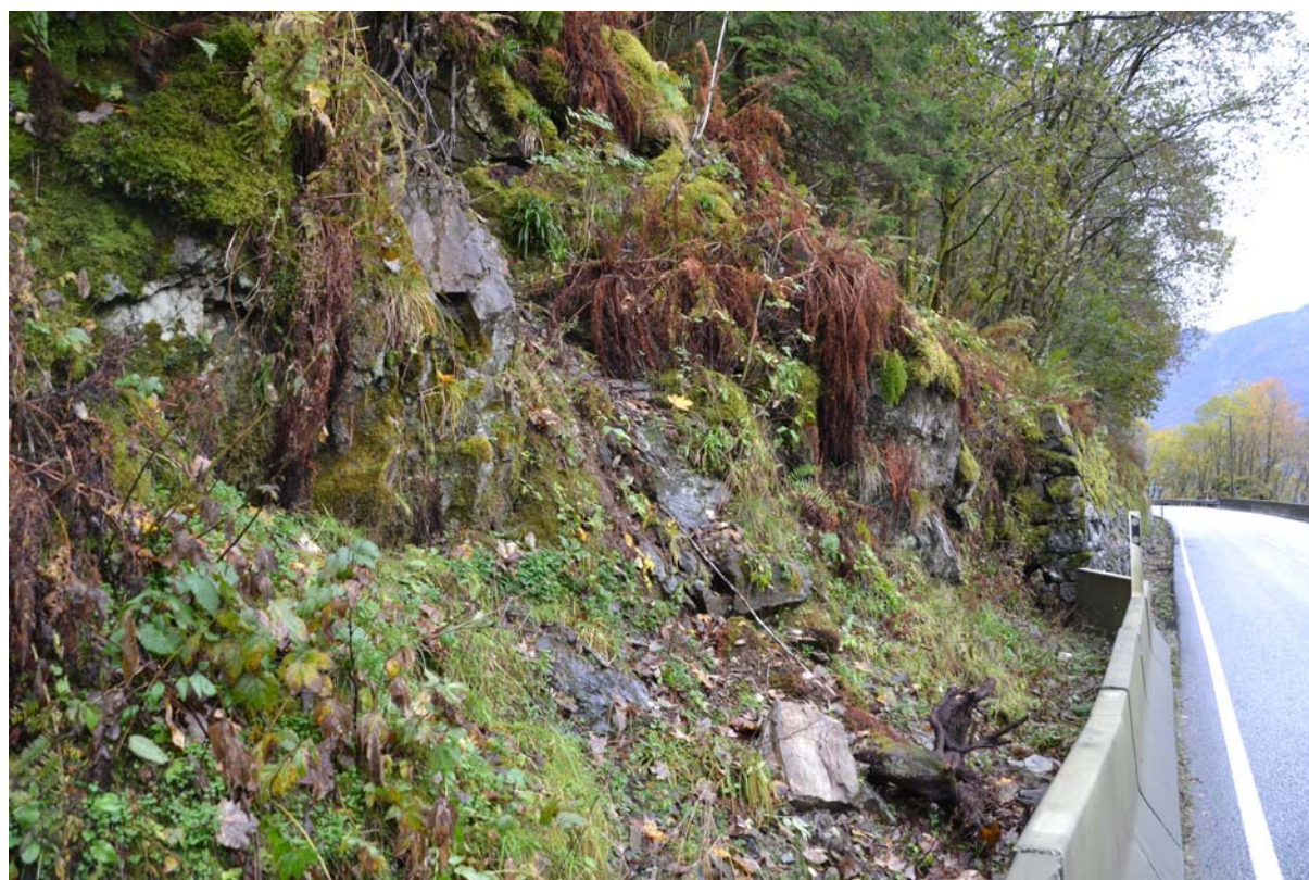
Figur 5. Betongelementa i biletet var plasserte rett under ein liten erosjonskant. Desse elementa vart påkøyrde og rivne ut i vegbana like etter synfaringa onsdag 15 oktober.
