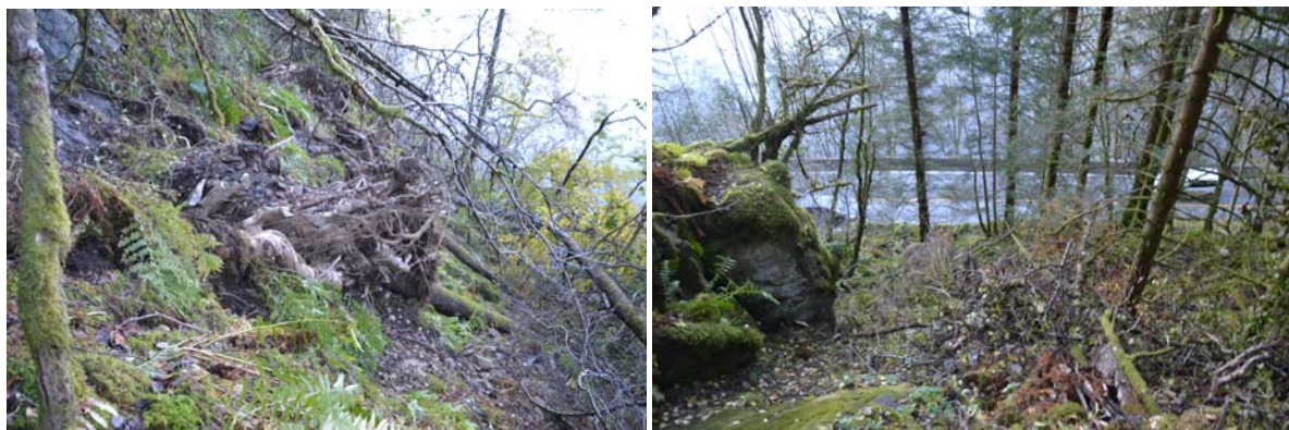
Figur 2. Ca km 3,770. Stein som kom fram ved rotvelter vart vaska ut i samband med nedbør og hamna i vegbana ved fleire høve.
