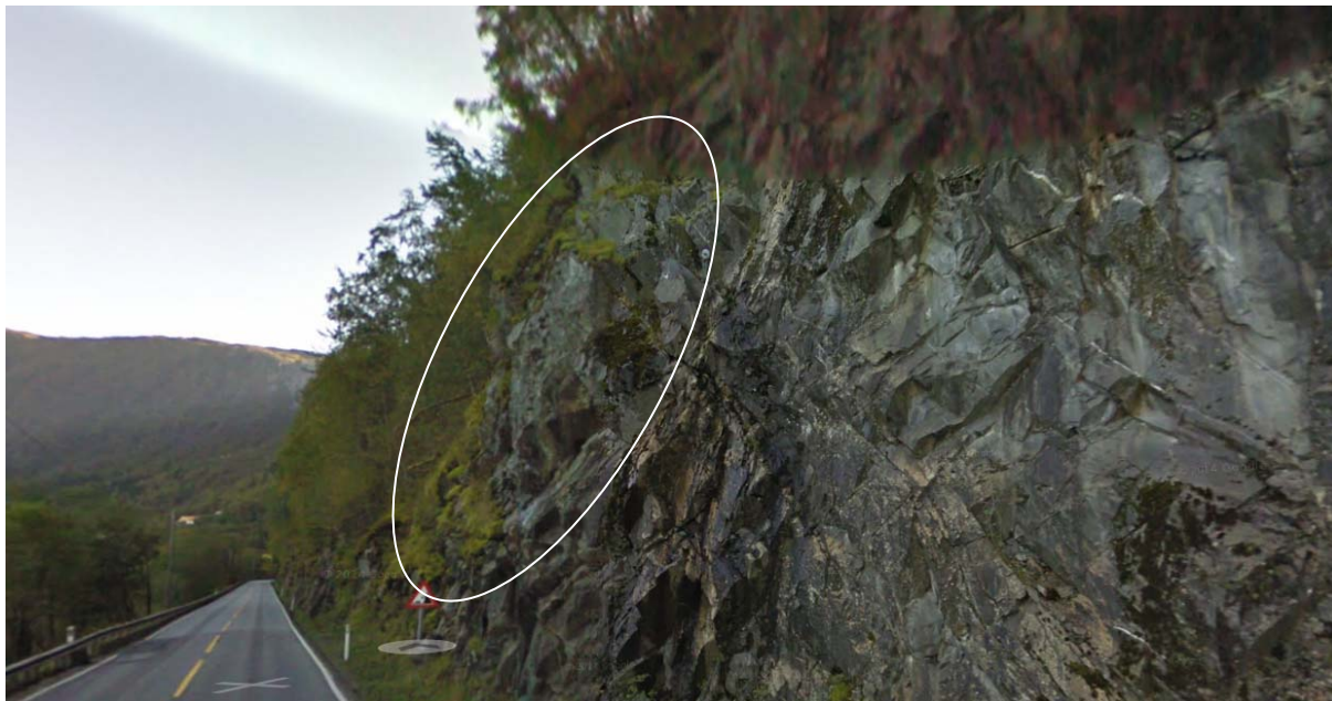
Figur 6. Om lag ved km 4,250 bør det setjast nokre boltar i skjeringa.
