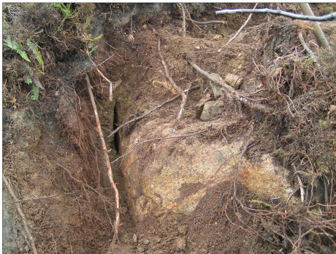
Figur 4. Nordre del av blokken sett ovenfra. Merk at det var en åpen sprekk under torvlaget. Denne observasjonen tydet på at blokken var i bevegelse.
