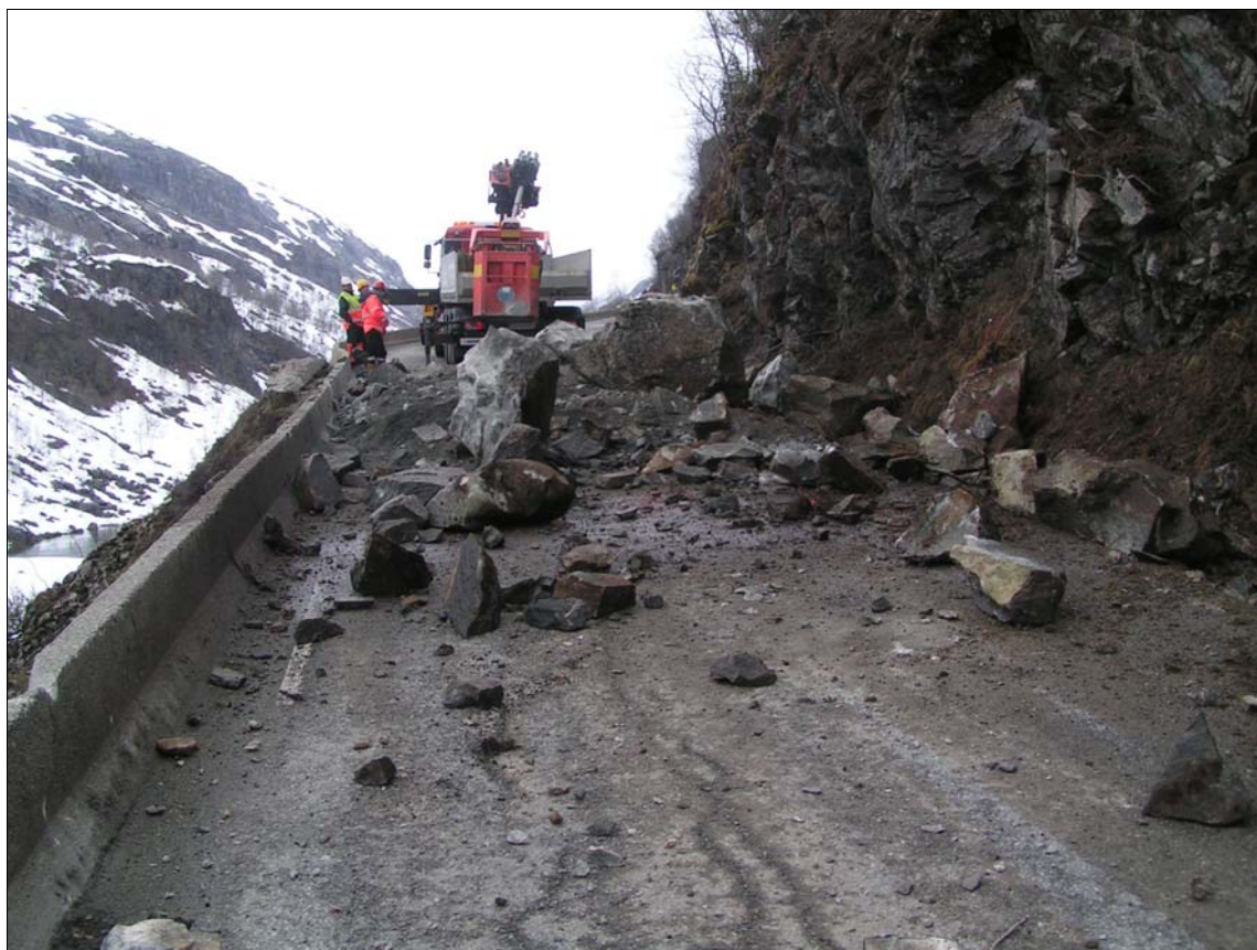
Figur 6. Skredmasser på vegen etter sprengning. En "gruspute" ble lagt for å beskytte vegen, og dette tiltaket var vellykket.
