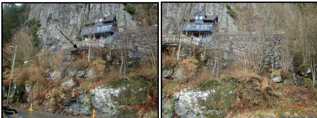
Figur 1. Deler av muren har rasa ut i vegbana. Den største muren til høgre i bileta kjem til å rase ut med tida.
