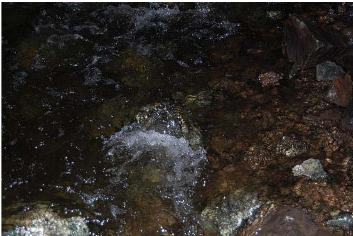
Figur 4. Nedfall i tunnelen
