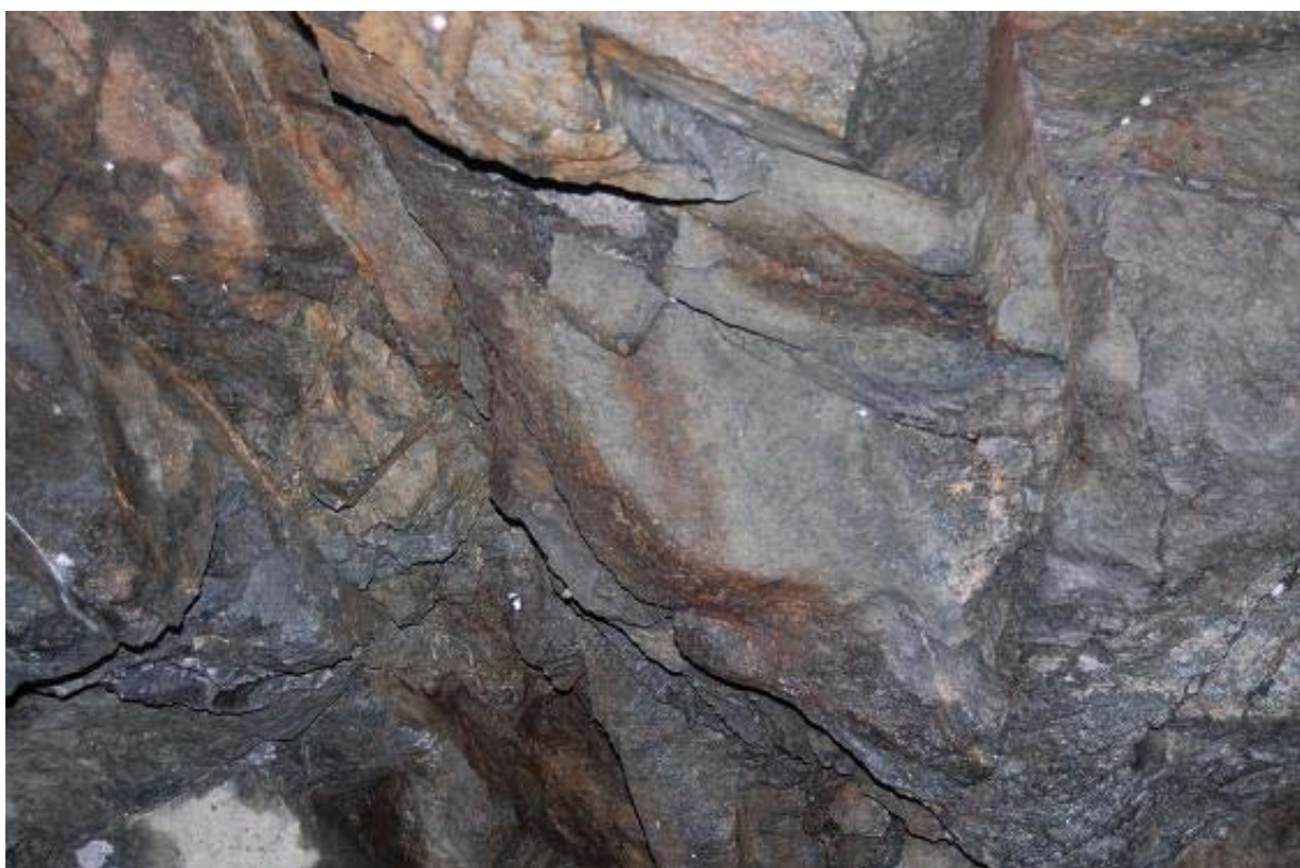
Figur 3. På grunn av forvitring langs soner og langs sprekker er det mange blokker som kan vere ustabile i området 0-20 m (målt i frå kulvert i sør).
