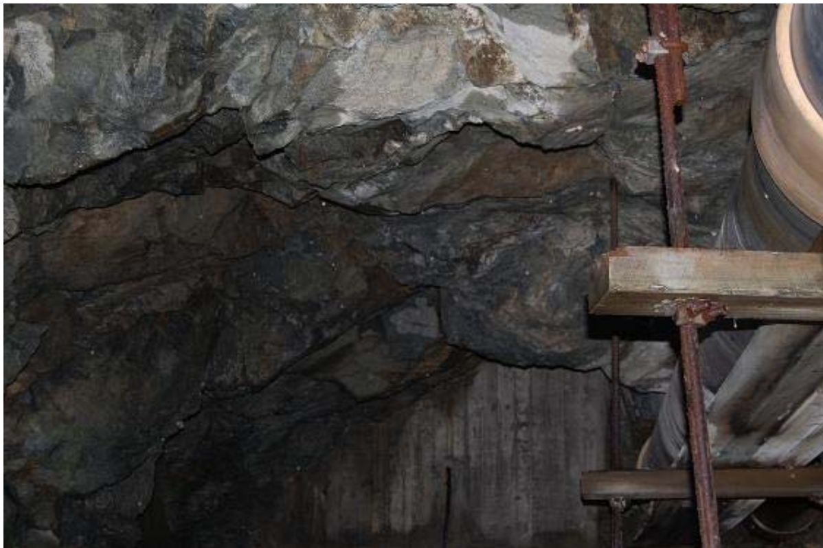
Figur 1. Biletet er teke 8 -10 m i frå betongveggen i sørenden. Bergmassen er dårleg. Eit røyr er festa i hengen. Ein stad er det observert eit usikkert festepunkt, moglegvis i ei sprekkeavløyst blokk.
