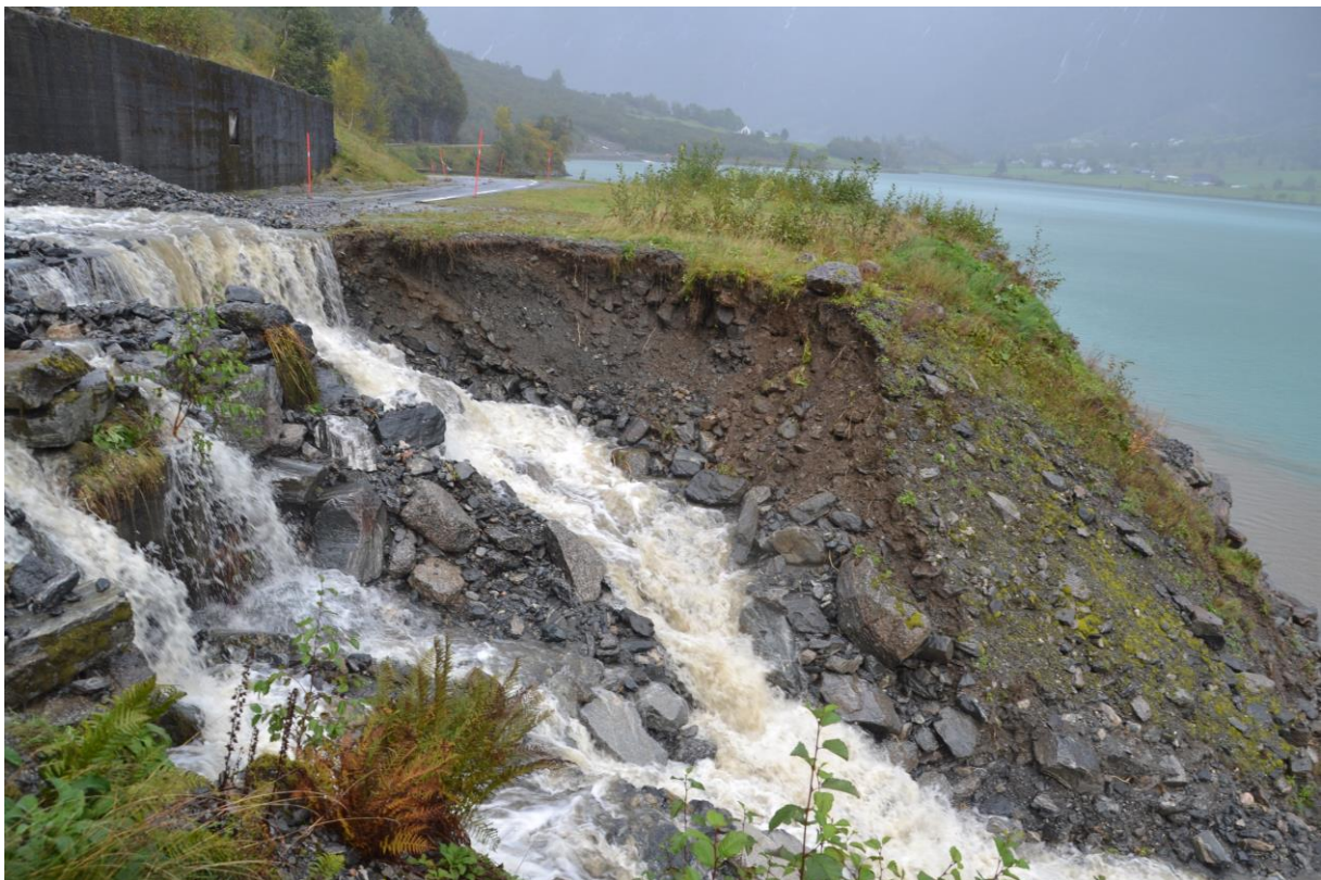
Figur 3 – Store skadar og kraftig erosjon på utsida av vegen
