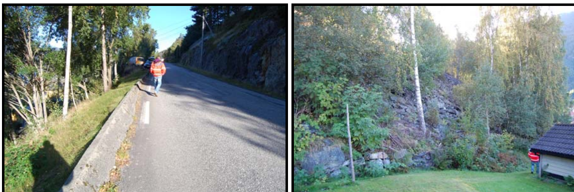
Figur 1. Setningsskadar, og mur som har lagt seg utover, er vist i venstre bilete. Høgre bilete viser eigendomen i foten av fyllinga.
