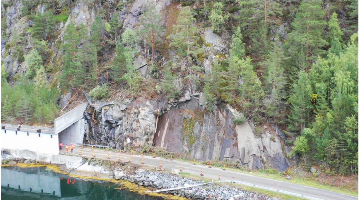
Figur 6. Fanggjerdet ovenfor vegen, deler av vegbana og autovernet er ødelagt som følge av steinspranget.
