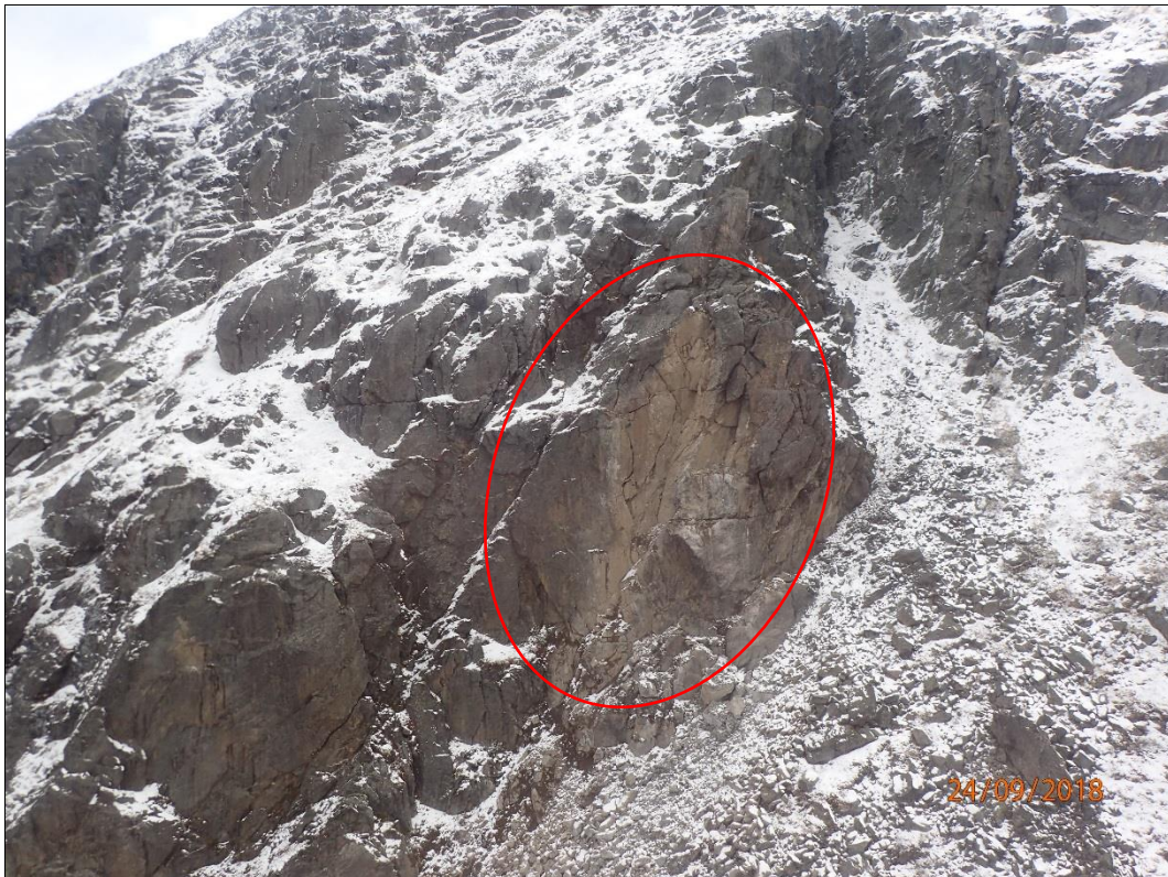
Figur 7: Løsneområdet. Utrast bergparti har stått steilt, og det ser ut til å ha vært dårlig/manglende understøtte/fot for dette. Til høyre for løsneområdet befinner det seg en blokkstabel, flere av blokkene her tolkes å ha dårlig stabilitet. Videre utover høsten og neste vårløsning tolkes det dit hen at man må forvente steinsprang fra dette partiet.
