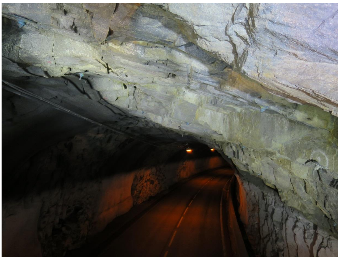
Bilde 1 – Flatt heng som kan føre til nedfall av «gravitasjonsblokker»
