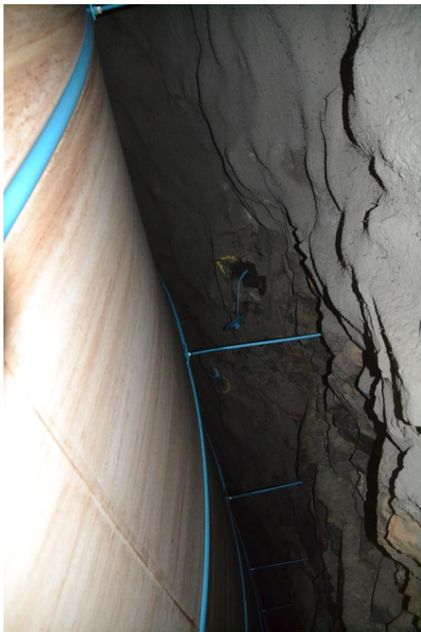
Bilde 5 - bolt hvor det har vært utfall bør kappes
