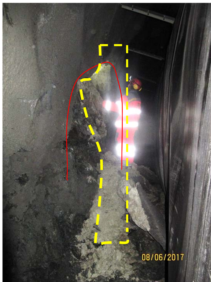
Foto 1: Profil 2330. Bergmasser og sprøytebetongflak på sålen. Utrast parti innenfor rød strek. Veggstøp innenfor gul stiplet strek.
