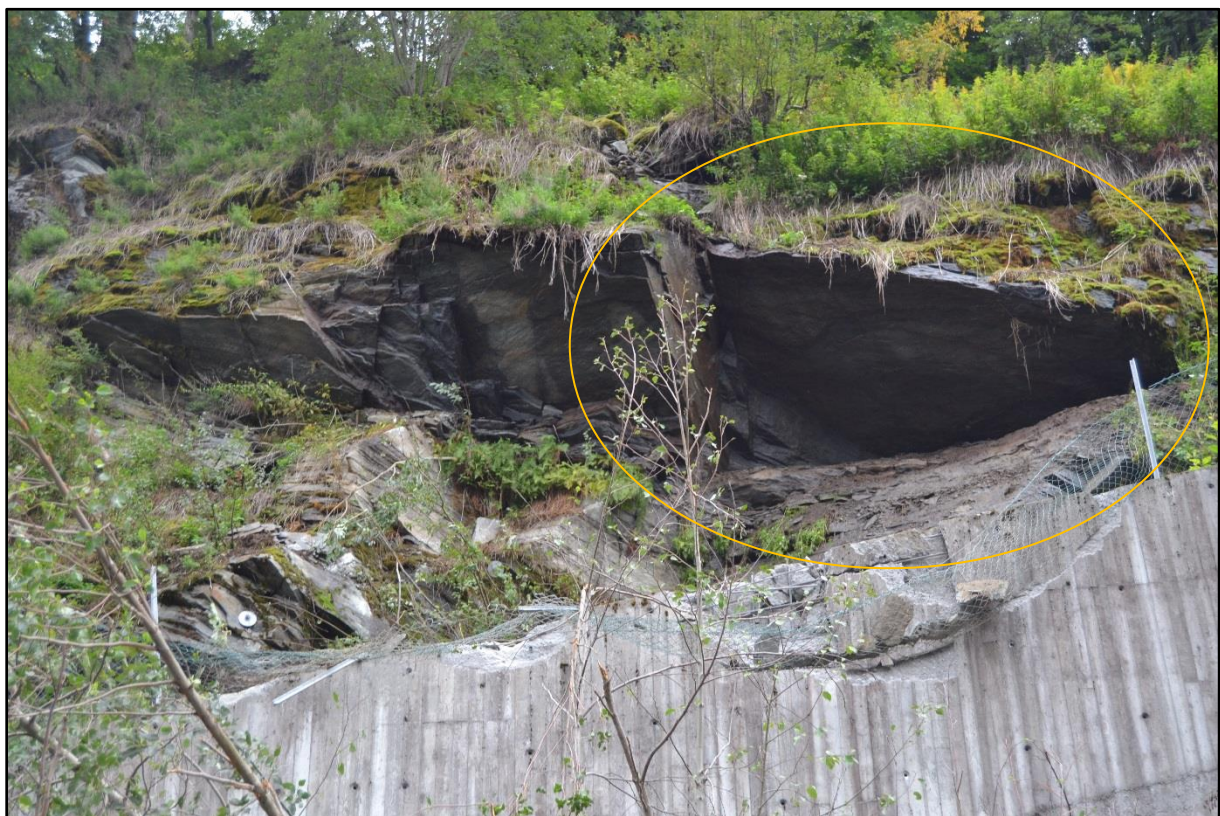
Figur 3: Bilde fra befaring 29.08.18. Det ser ut til at ytterste del av overhenget har løsnet, ser ikke ut til at det har vært blokker langs sleppen i underkant av overhenget som har fungert som fotstøtte.
