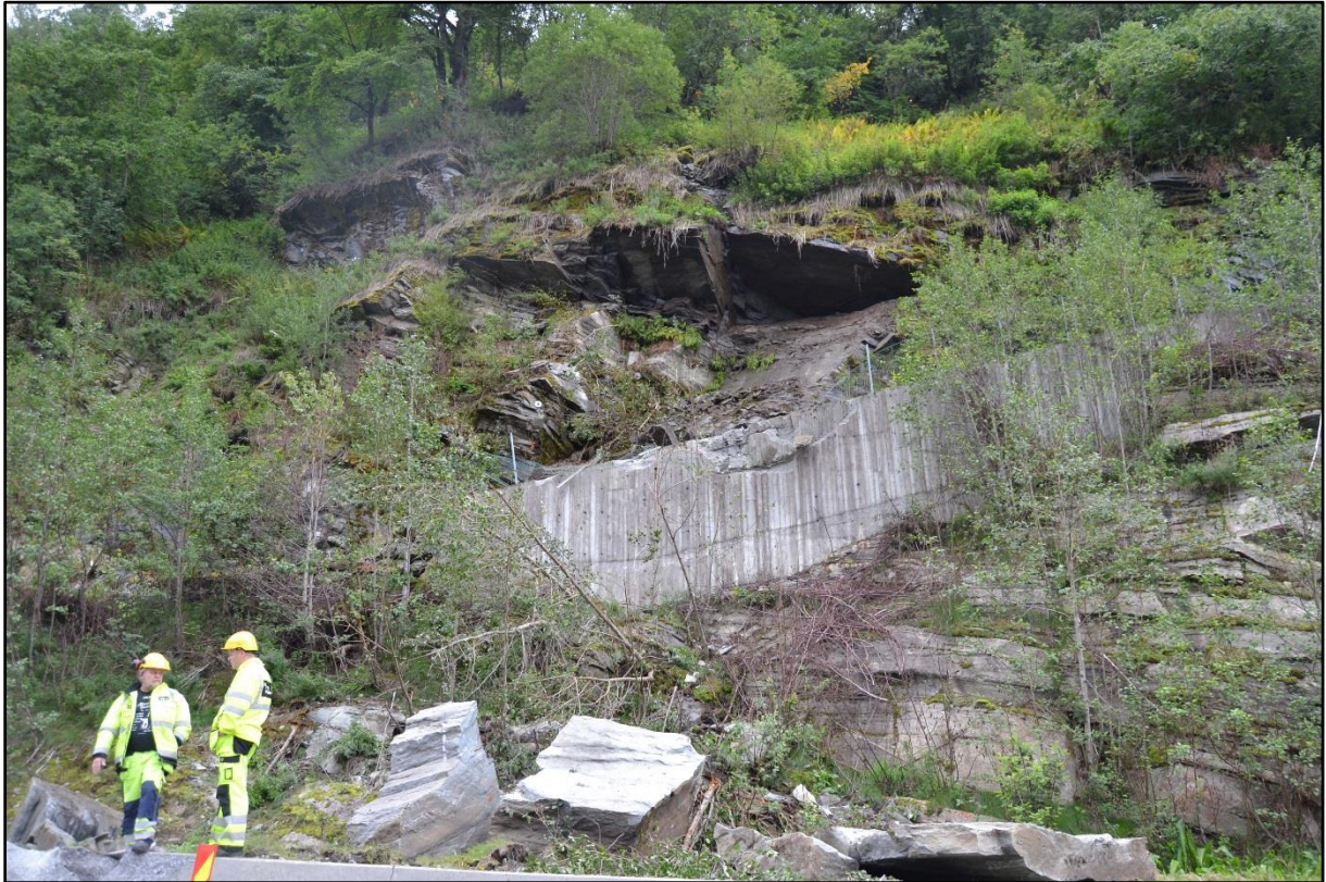
Figur 1: Løsneområdet er lokalisert i bergvegg 10-15 meter over vegbane, rett ved tidligere anleggsveg for Myrkdaltunnelen.
