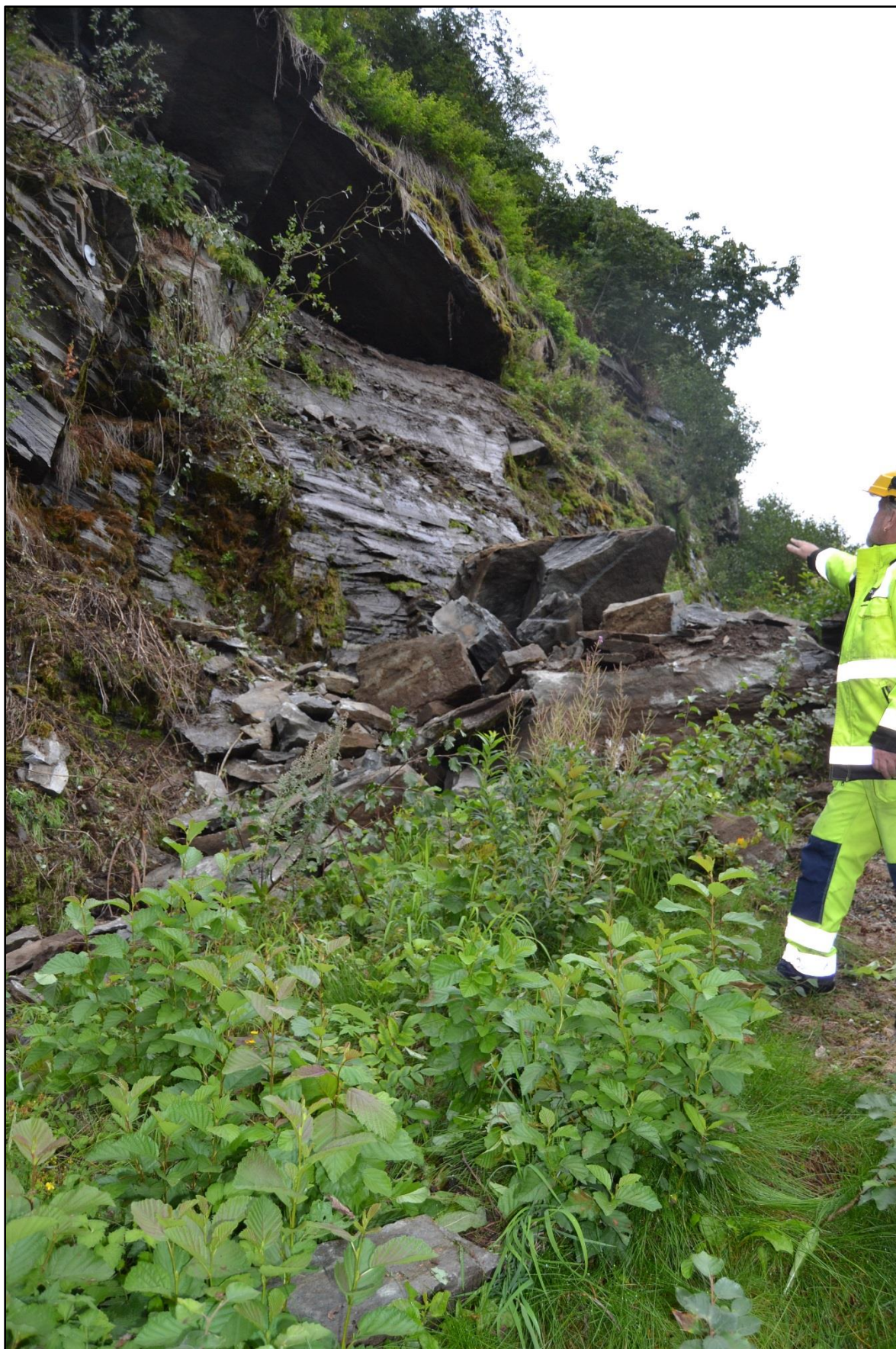
Figur 4: Anleggsveg under bergveggen. Det anbefales at skredmassene ryddes og legges opp til en liten voll langs betongkanten ut mot riksvegen. Dette for at eventuelt nye skred har plass til å stoppe i anleggsvegen.
