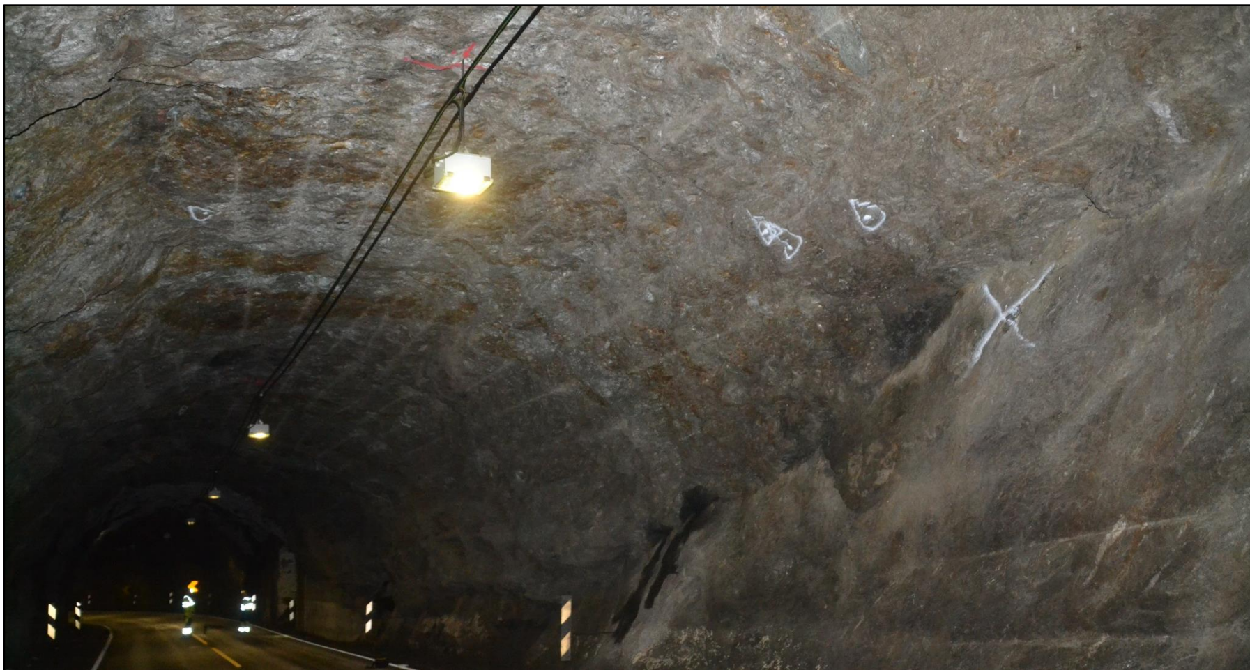
Figur 5: Parti i høyre side ved lengde 220-250 som manglar understøttelse. Langs sleppa er det litt vatn å sjå.
