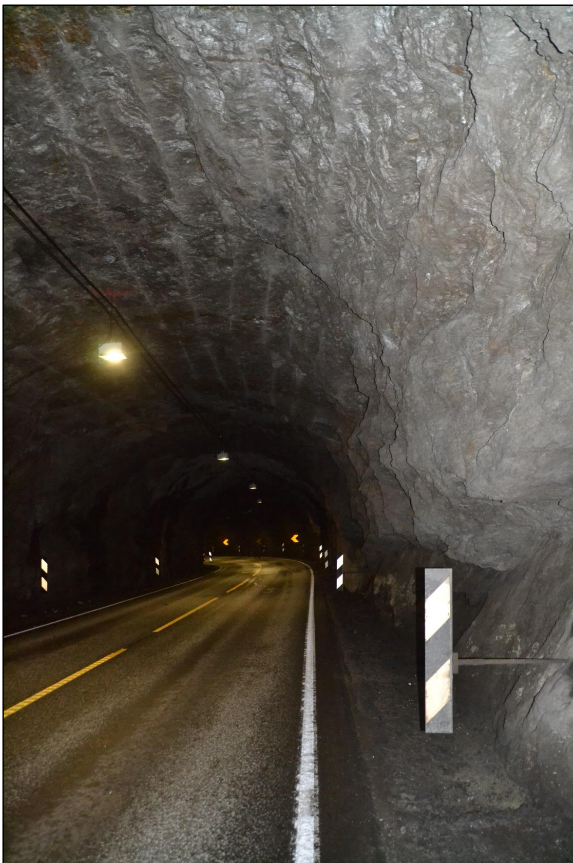
Figur 4: Parti ved lengde 220-250 i høyre side som manglar fot.
