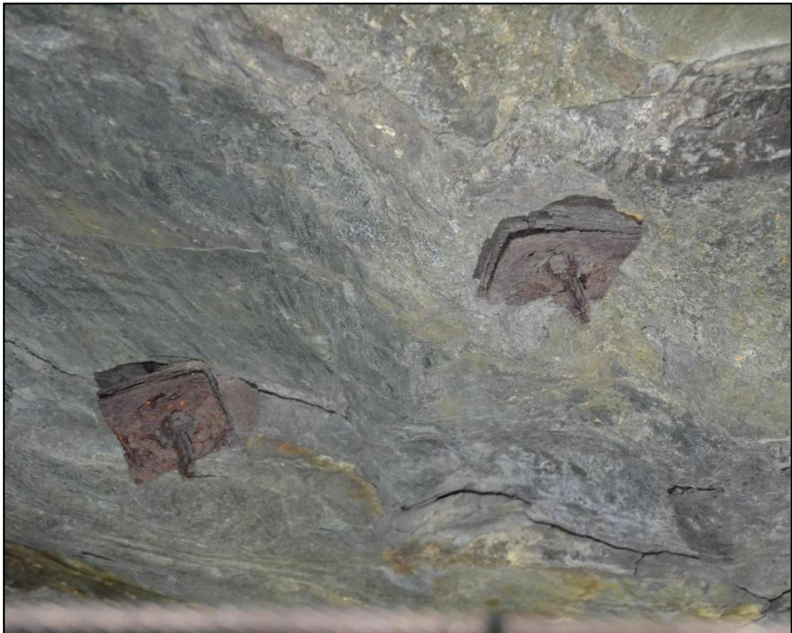
Figur 2: Fullstendig gjennomrusta og forvita boltar. Alderen på bergsikringa er truleg frå 1956 når tunellen opna.
