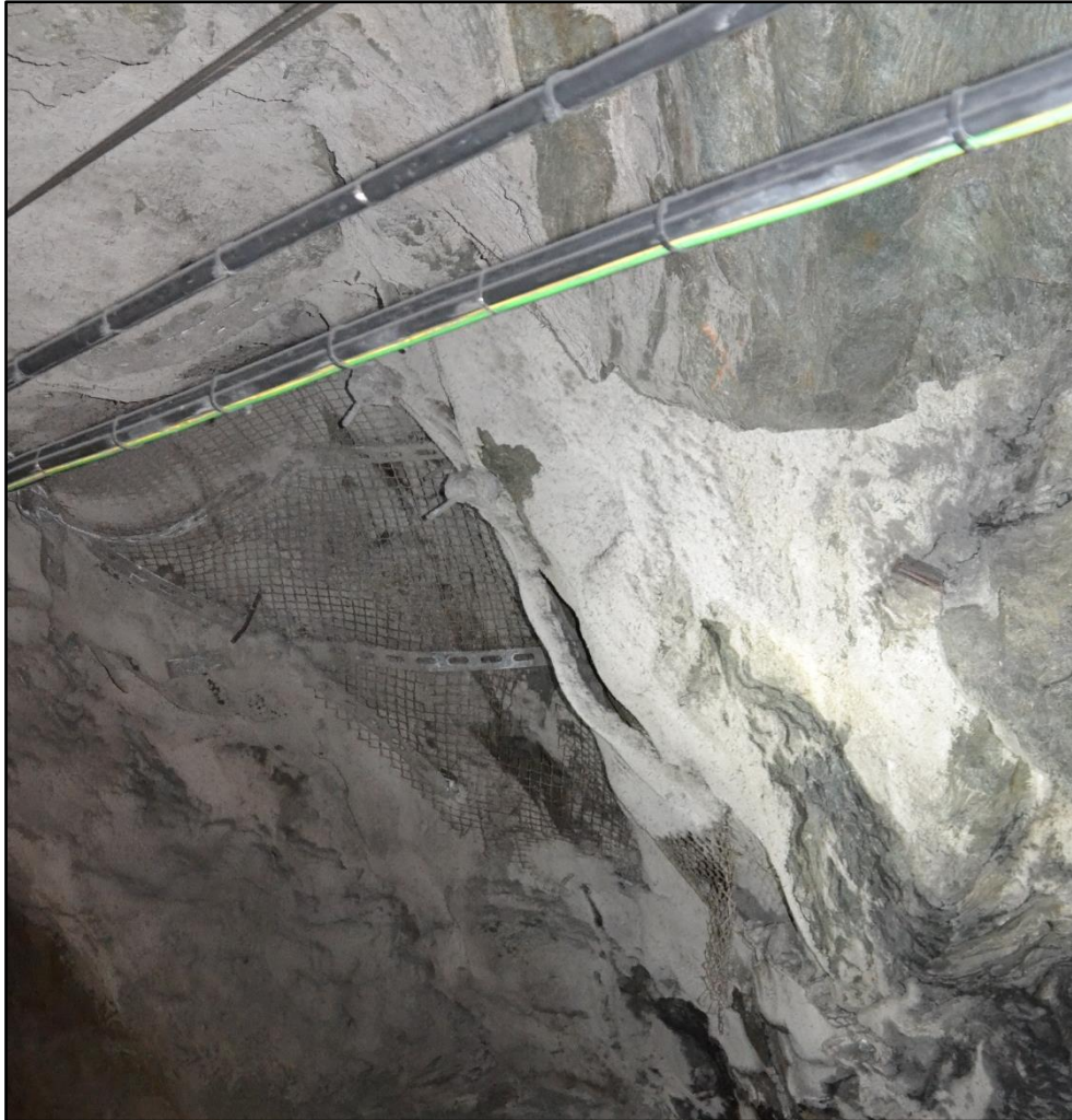
Figur 3: Sprutbetong med fiber som har losna frå fjellet og står i fare for å ramle ned i vegen.
