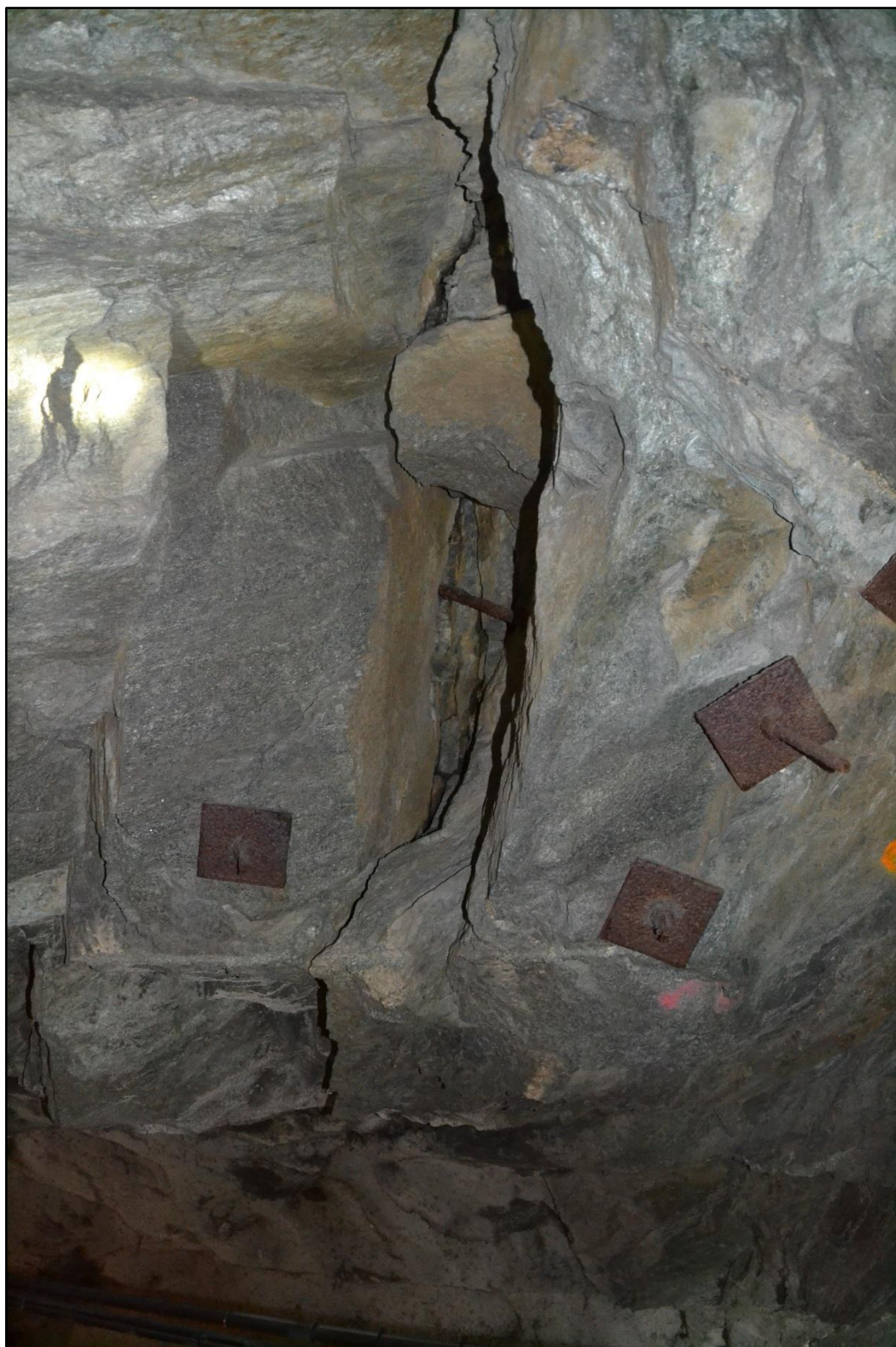
Figur 6: Gjennomrusta og forvittra boltar. Sjølve kamstålet som går gjennom sprekkka ser ut til å vere i dårleg forfatning.
