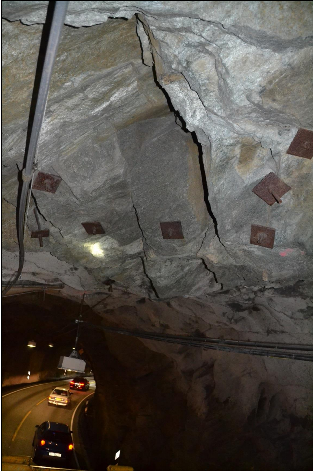
Figur 5: Gjennomrusta og forvitra boltar som truleg stammar frå 1956 når tunellen opna.
