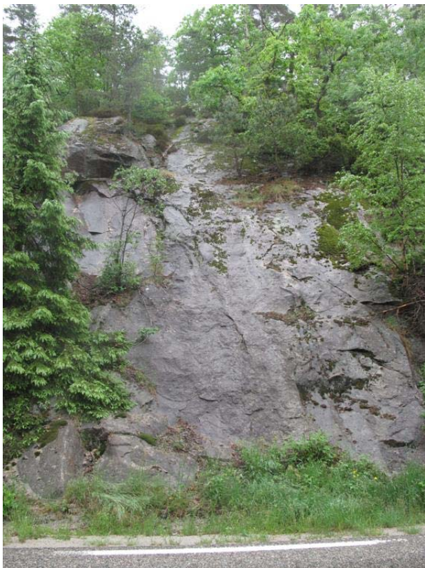
Figur 3: Parti tilsynelatende utsatt for vannsig.
