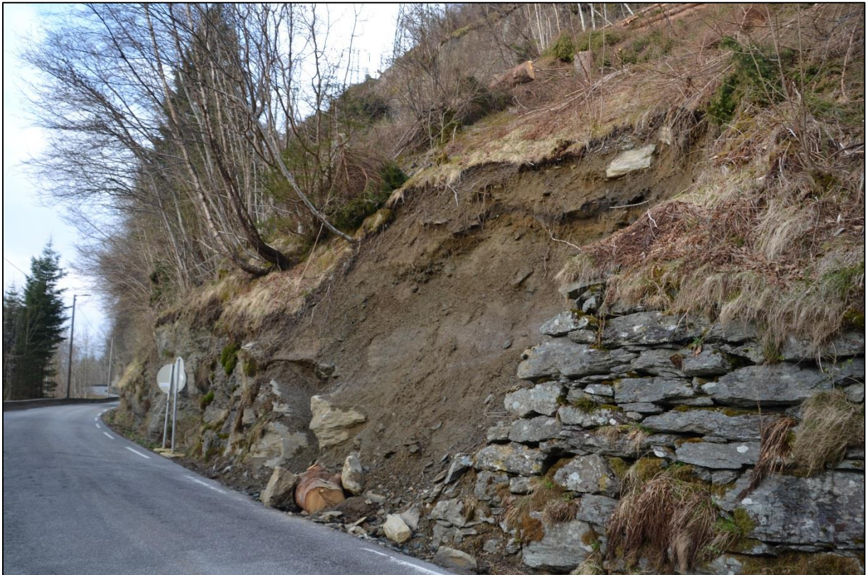
Figur 1: Utglidning av jord ved Fv 360 hp 1 km 13.350
