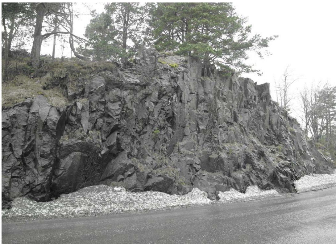
Figur 5: Skjæring på sydsiden av vegen. Mye sprekker, vegetasjon i skjæringen.
