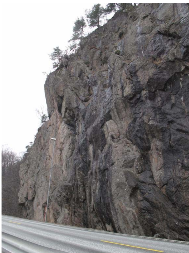
Figur 2: Fuktparti (mørke felt i skjæringen). Bilde mot vest.
